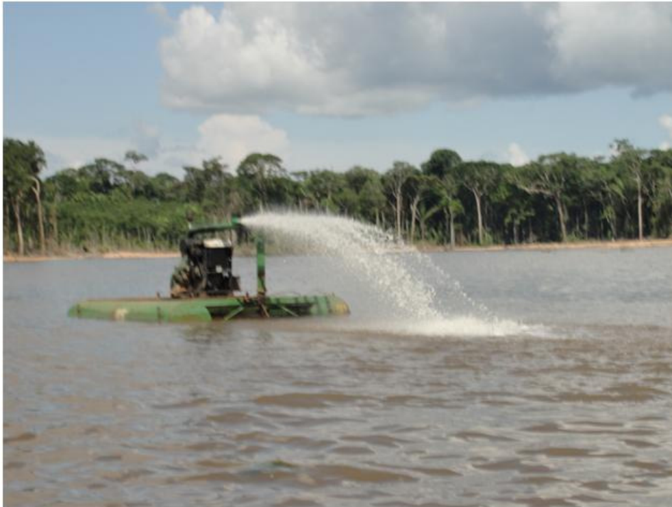
FIGURA 51: Igarapé Ceará: Bomba sobre balsa instalada para aeração da água.
