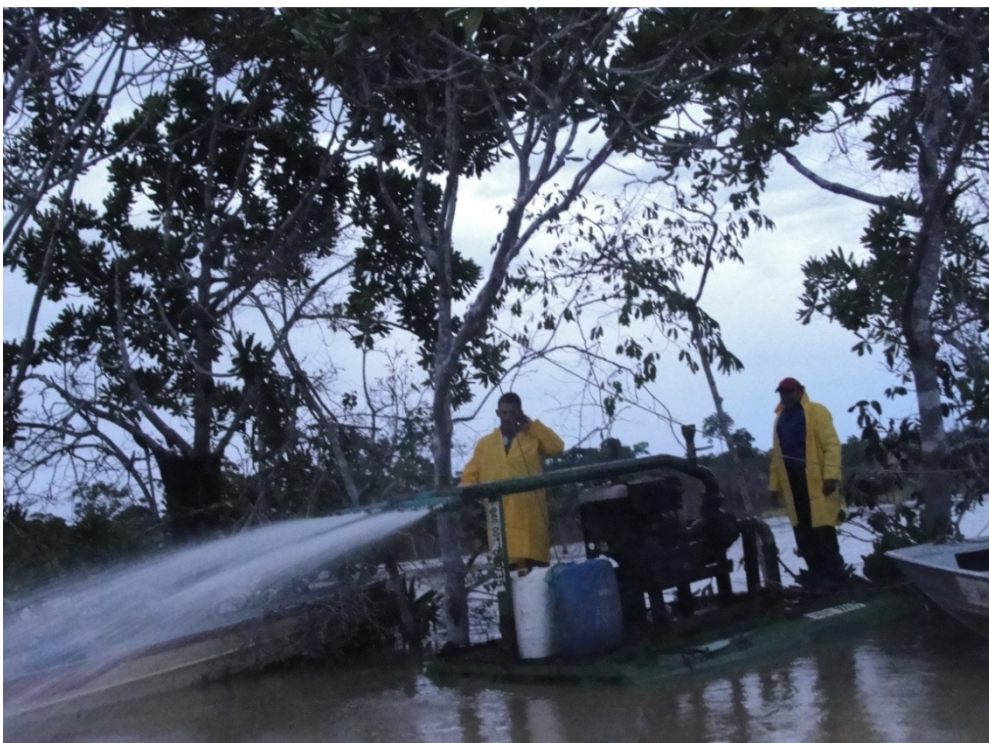
FIGURA 50: Igarapé Jatuarana I: Bomba sobre balsa instalada para aeração da água
