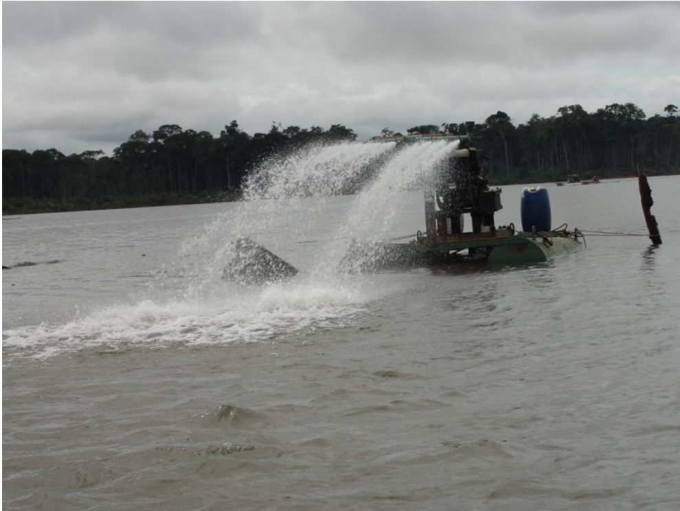
FIGURA 49: Igarapé Jatuarana I: Bomba sobre balsa instalada para aeração da água.
