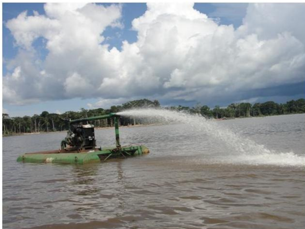
FIGURA 52: Igarapé Ceará: Bomba sobre balsa instalada para aeração da água.
