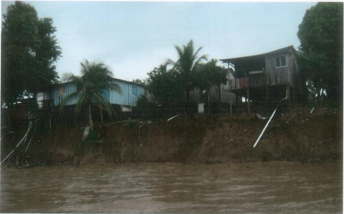
Foto 3 – Área com presença de sedimentos de baixa consistência.
