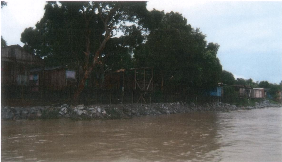
Foto 7 – Detalhe da proteção de enrocamento na área do “bairro Triangulo”. Área crítica, com árvores tombadas.
