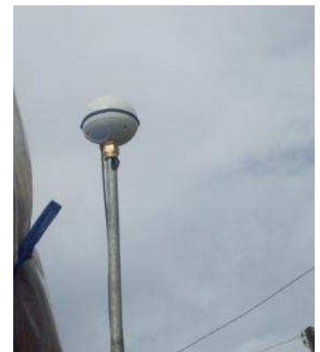
Antena para DGPS
