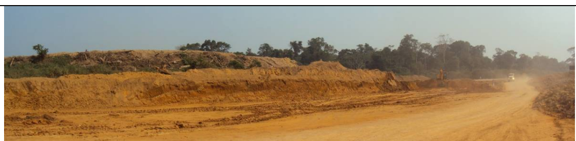
Figura 1. Área de escavação próxima à portaria da Vila Princesa, adjacente ao aterro sanitário.
