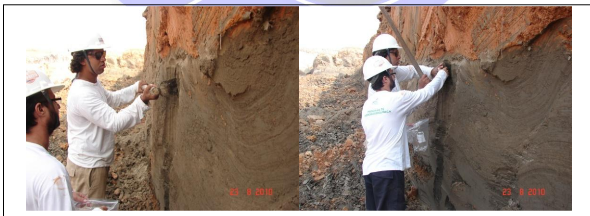
Figura IX.2. Coleta de amostras de sedimento no canteiro de obras da UHE–Santo Antônio.
