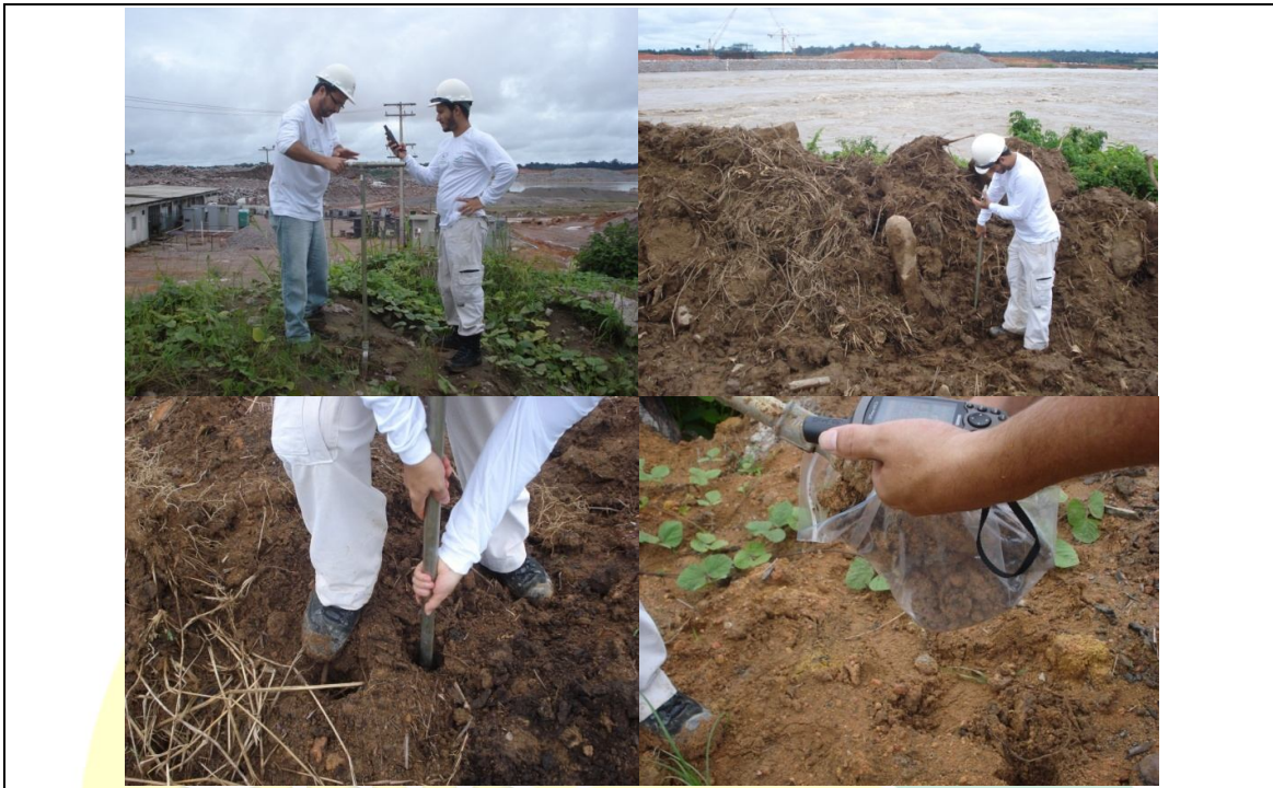
Figura X.2 - Coleta de amostras de solo e sedimento no canteiro de obras da UHE –Santo Antônio.
