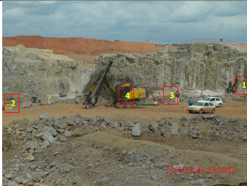
FOTO 01 – Localização inicial da perfuratriz (1); local onde o caminhão estacionou para desembarque do Sr. Walber (2); local onde o Sr. Hugo foi abordado pelo Sr. Walber (3); local do acidente (4);
