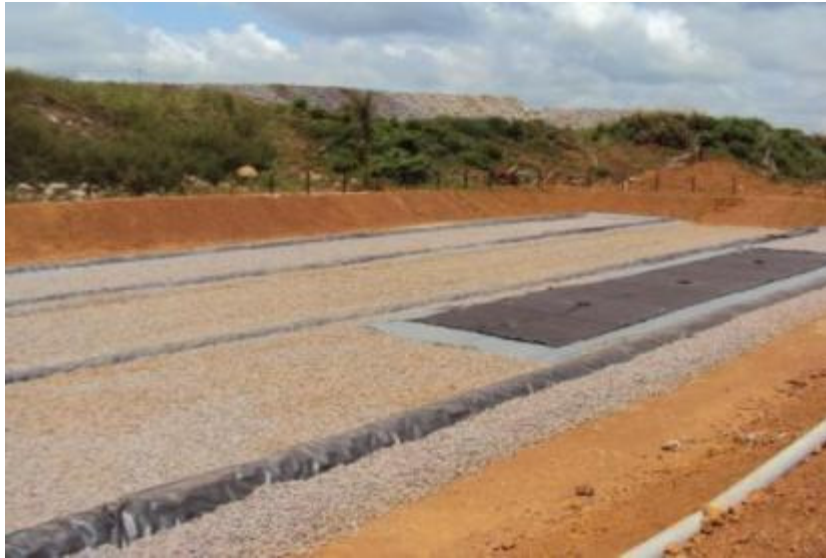
Instalação do Tratamento do Lodo ETA – 300 m 3
