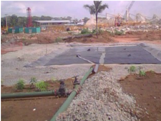
Sistema de tratamento de lodo – ETA 20m 3 /h
