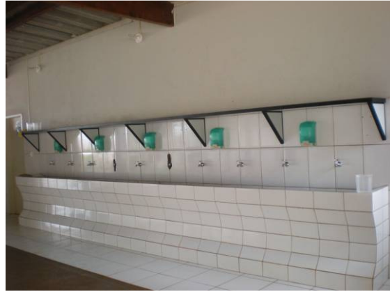
Lavador de mãos – área refeitório
