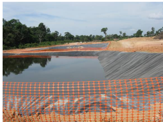
Estação de Tratamento de Esgoto – ETE - Lagoas de estabilização.
