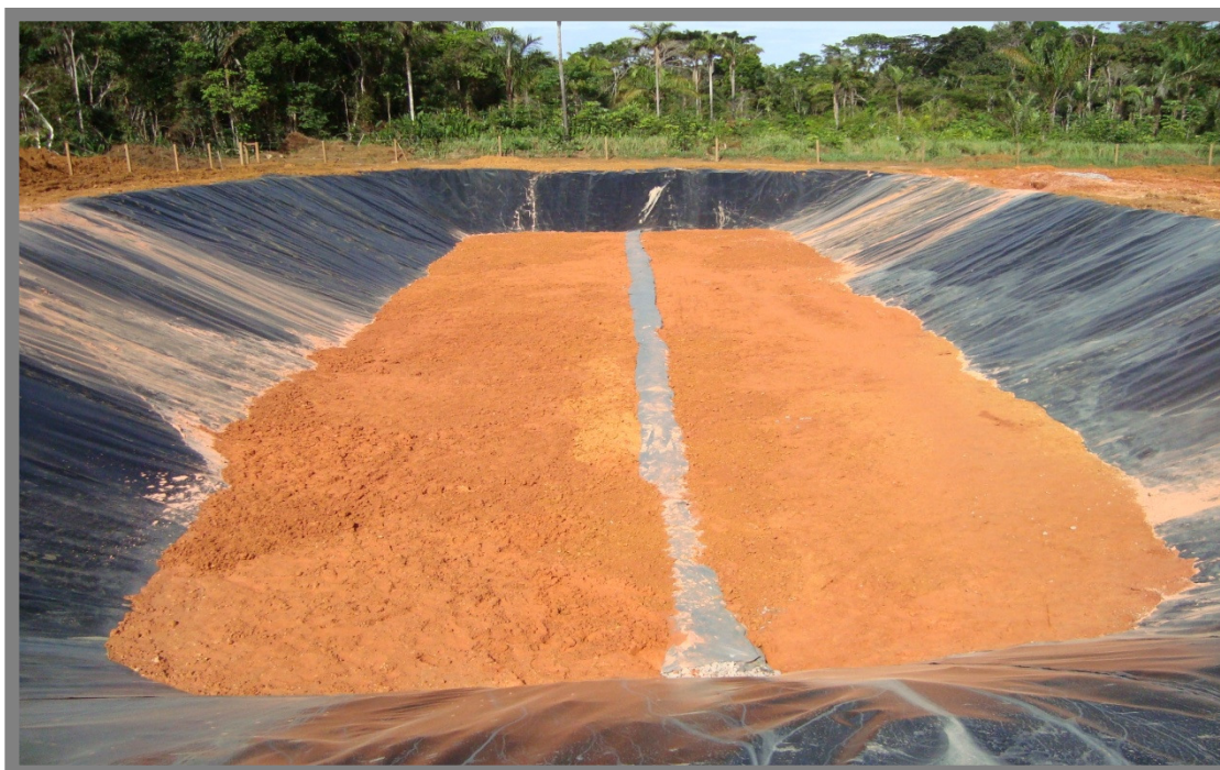
Aterro sanitário ME – Célula para disposição de resíduos em fase de implantação
