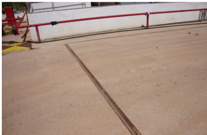
FOTO 4 – Posto de abastecimento MD – sistema de canaletas na área de abastecimento
