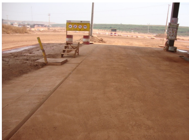
FOTO 2 – Posto de abastecimento ME – sistema de canaletas na área de abastecimento.
