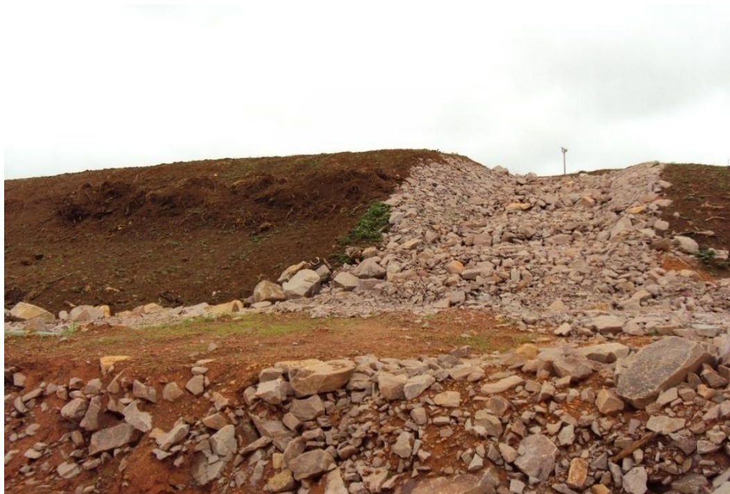
Quadro nº 21 – Calha de drenagem com proteção de rocha construída no bota fora ME
