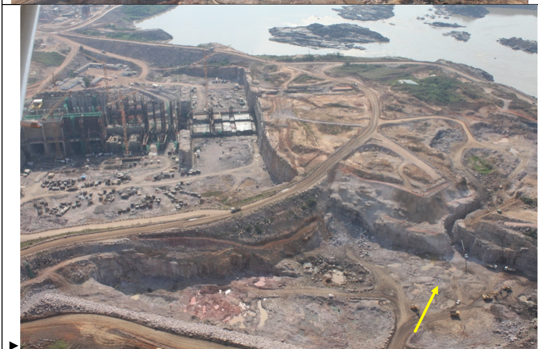
▶ Nestas fotos aéreas estão bem caracterizados os trabalhos de escavação na região do portal direito do STP da ilha do presídio (setas)
