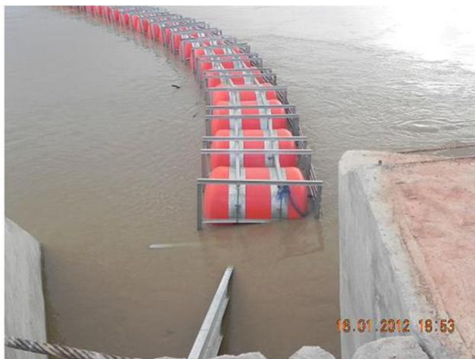
Figura 25 – Log-boom de proteção – Casa de Força – Blocos 5-4.
