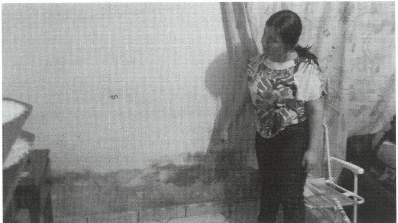
Foto 11: Casa com as paredes marcadas pela umidade devido à saturação do solo.
