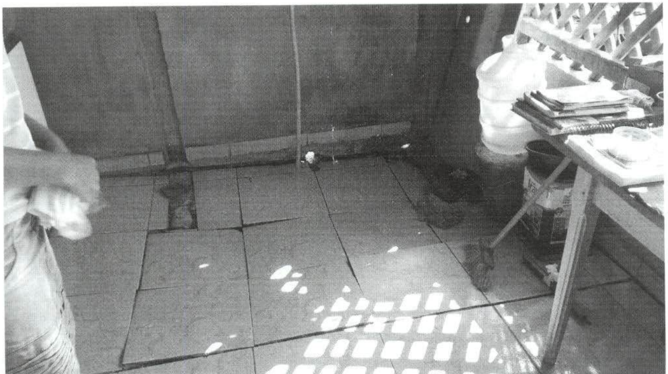
Foto 4: Piso cedendo devido à infiltração do terreno: Bairro da Lagoa
