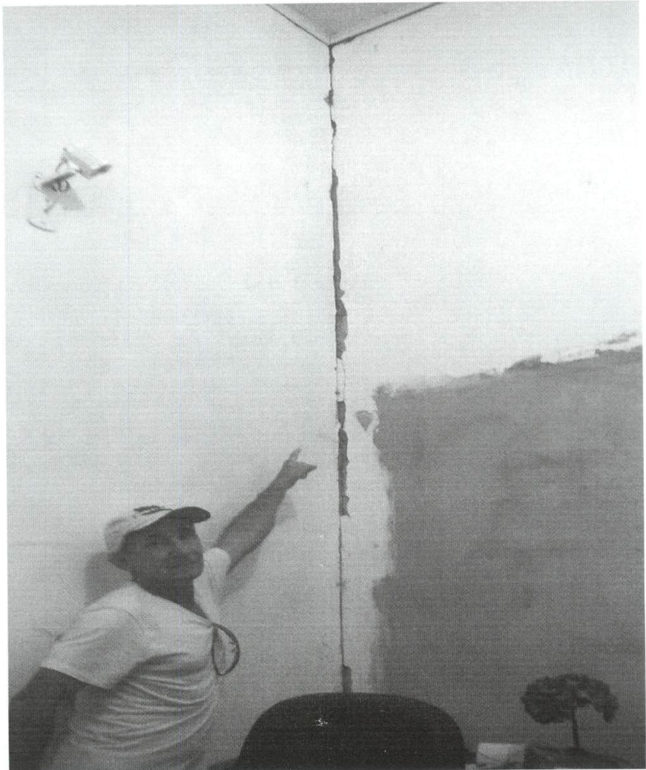
Foto 14: Danos ocasionados nas estruturas de comércio localizado na rua Sebastião Gomes.
