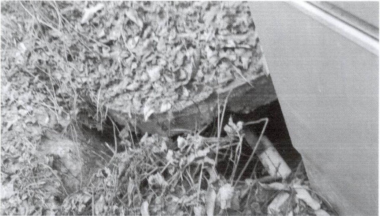
Foto 18: Terreno cedendo em uma pousada localizada no bairro Velha Jaci.
