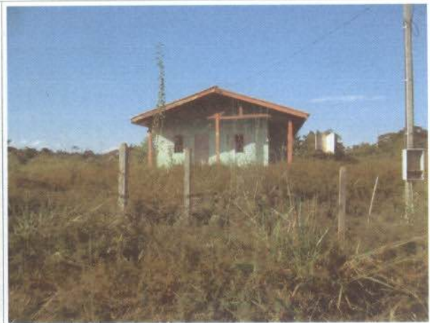
Foto 02. Moradia com aspecto de abandono - Vila Nova Teotônio.
