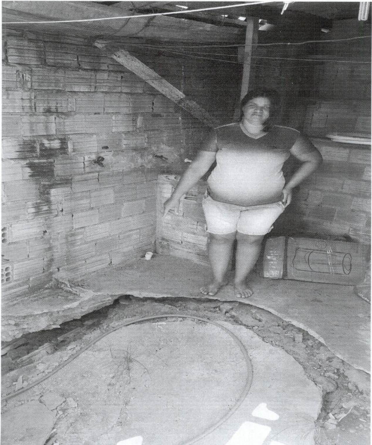
Foto 9: Fossa de comércio localizado na rua Sebastião Gomes. Risco à integridade física da comerciante.
