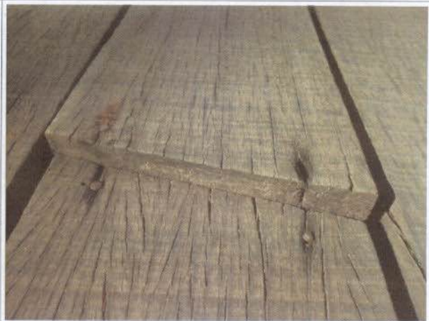
Foto 08. Pier de madeira - tábuas soltas - Vila Nova Teotônio.
