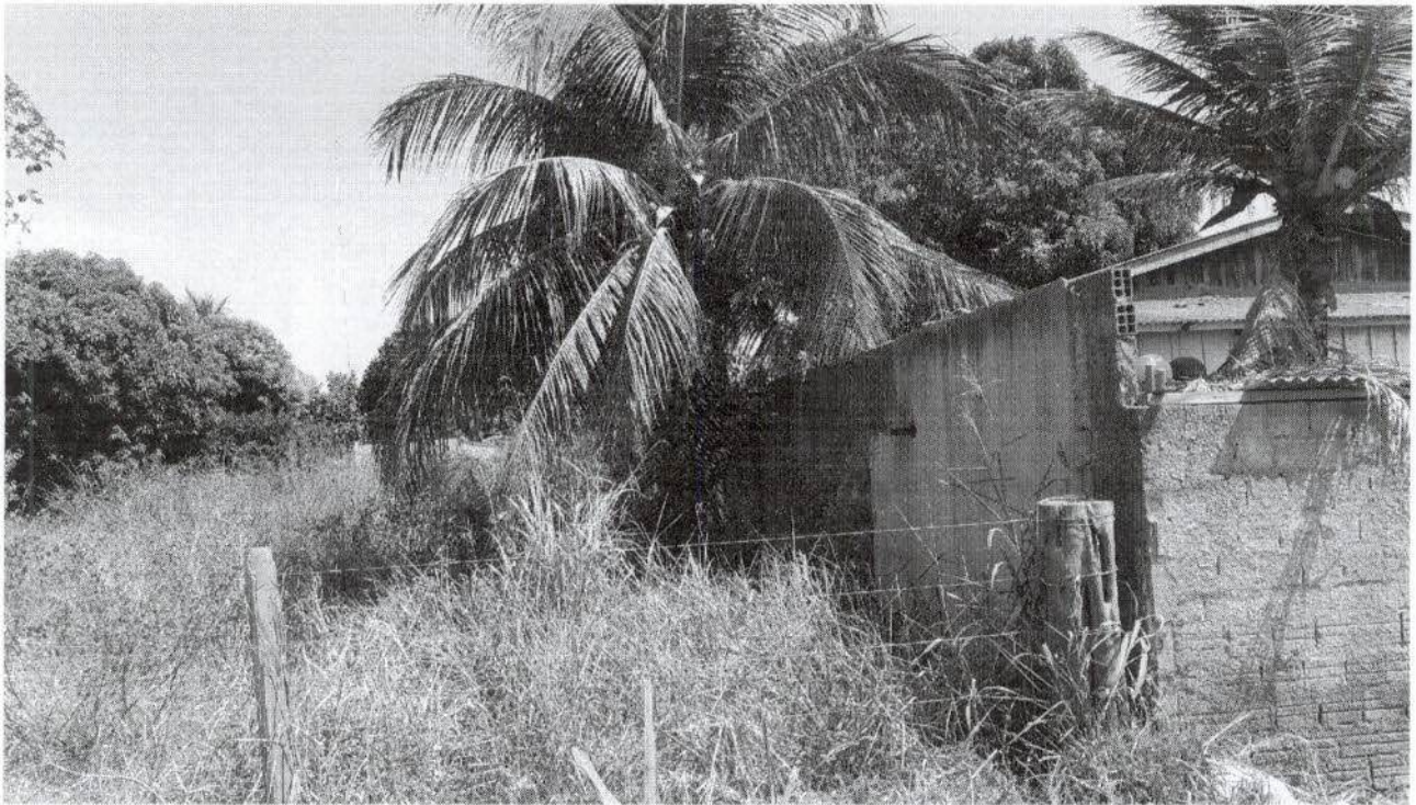
Foto 12: Terreno baldio decorrente de remanejamento. Muro com problema estrutural, podendo cair a qualquer momento.
