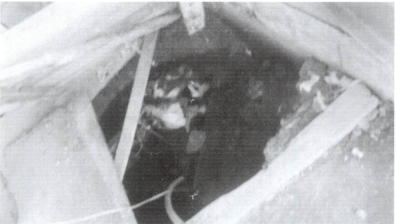
Foto 19: Estrutura cedendo no mesmo imóvel.
