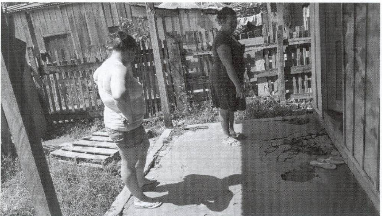
Foto 13: Terreno alagado provocando danos na estrutura da casa, piso cedendo.
