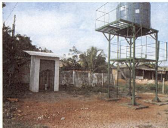
Foto 04. Poço artesiano – bairro Trilhal
