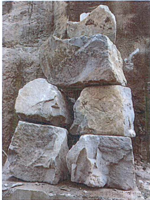
Figura 5. Vãos entre matacos num defletor do Sistema de Transposição de Peixes da UHE Santo Antônio.
