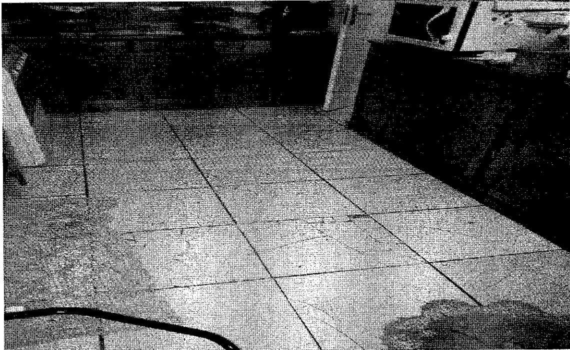
Foto 9. Piso fragmentado potencializando risco de acidentes.
