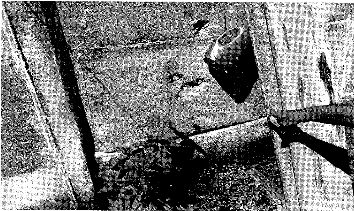
Foto 4. Blocos do muro se desprendendo.
