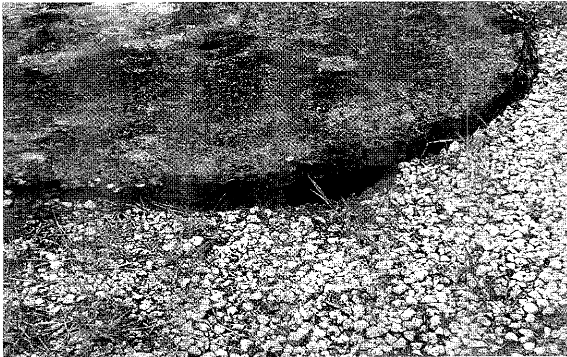
Foto 7. Rompimento da fossa ocasionando a exalação de odores desagradáveis e acumulando muitos mosquitos – lote 37.
