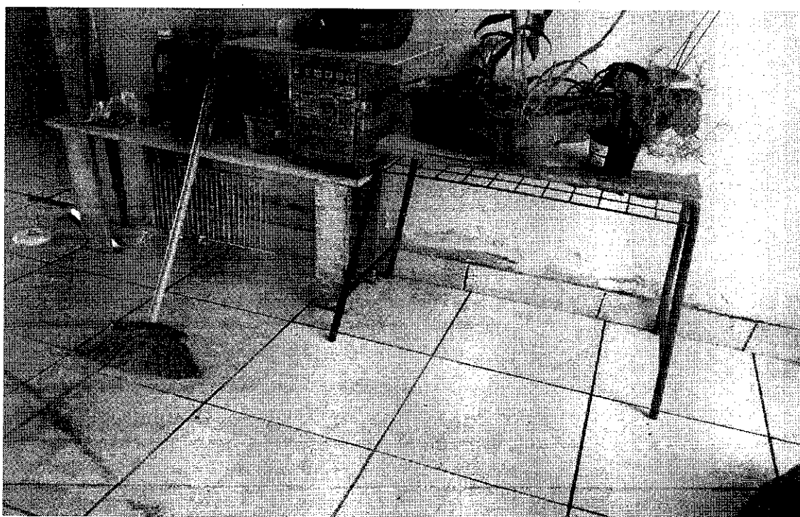
Foto 8. Ação da infiltração nas paredes da casa.
