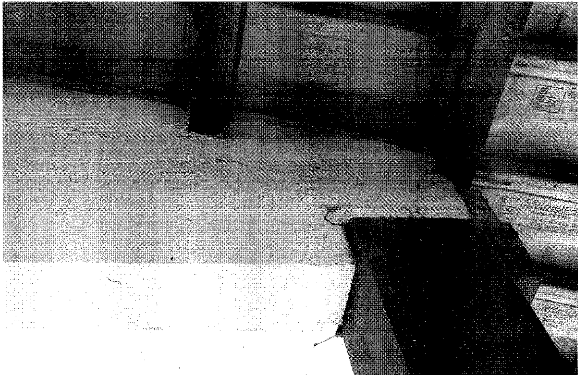
Foto 13 – Rachaduras na sustentação da varanda de uma das casas.
