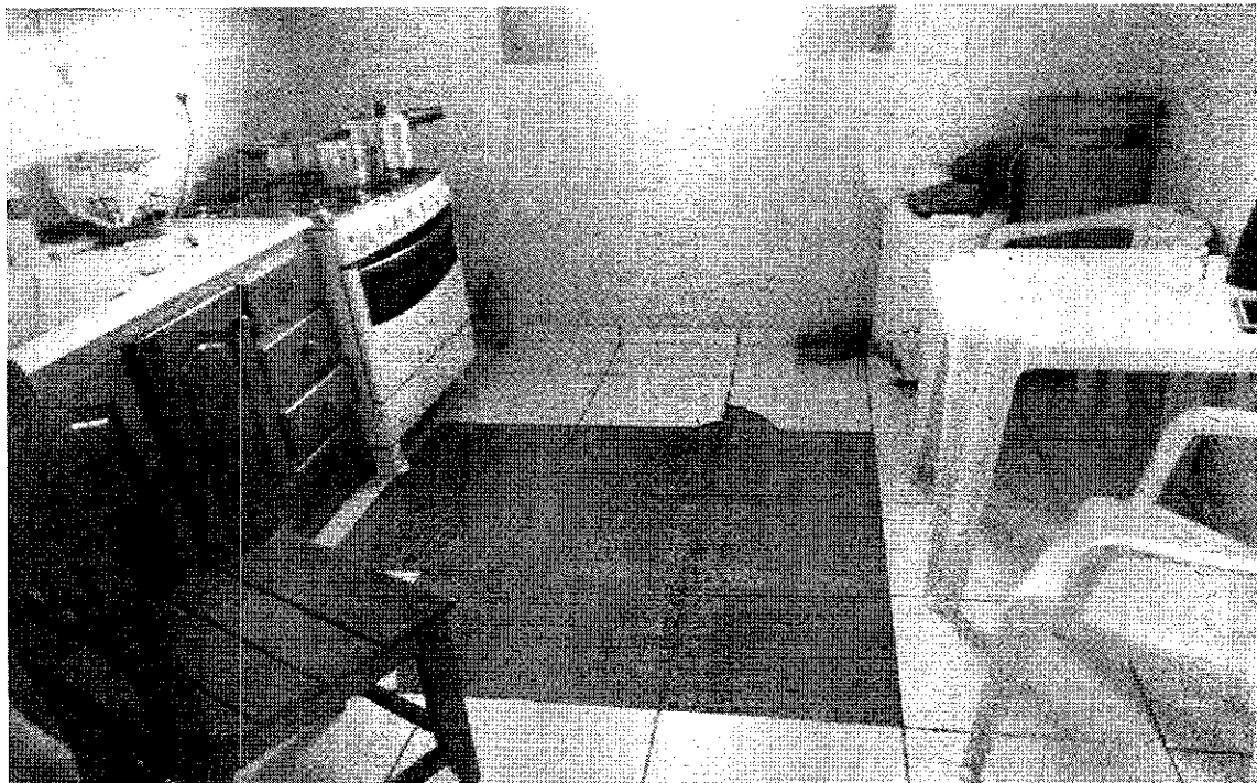
Foto 2 – Mesma situação na parte interna (cozinha) da mesma residência.
