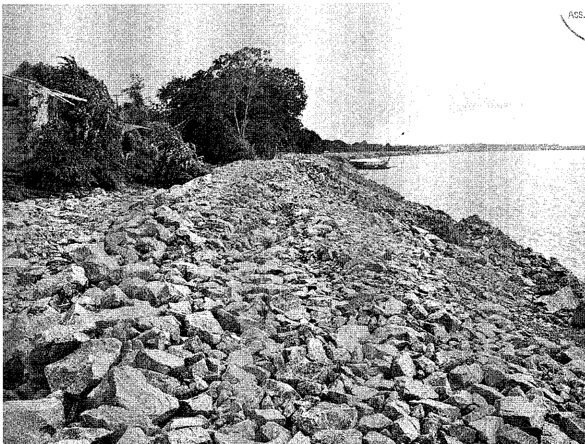
Foto 03 – Tirada próximo às residências afetadas pelos desbarramentos. Sentido UHE Santo Antônio.
