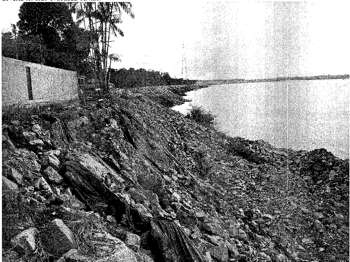
Foto 10 – Casa com muro recém construído próximo a talude desbarrancado. Não foi possível verificar se a moradia deveria ter sido evacuada ou não.
