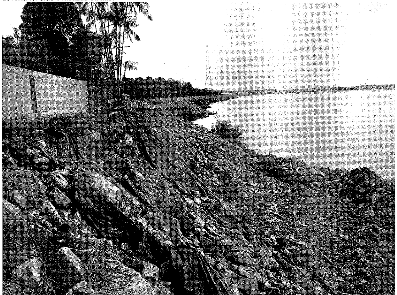
Foto 10 – Casa com muro recém construído próximo a talude desbarrancado. Não foi possível verificar se a moradia deveria ter sido evacuada ou não.
