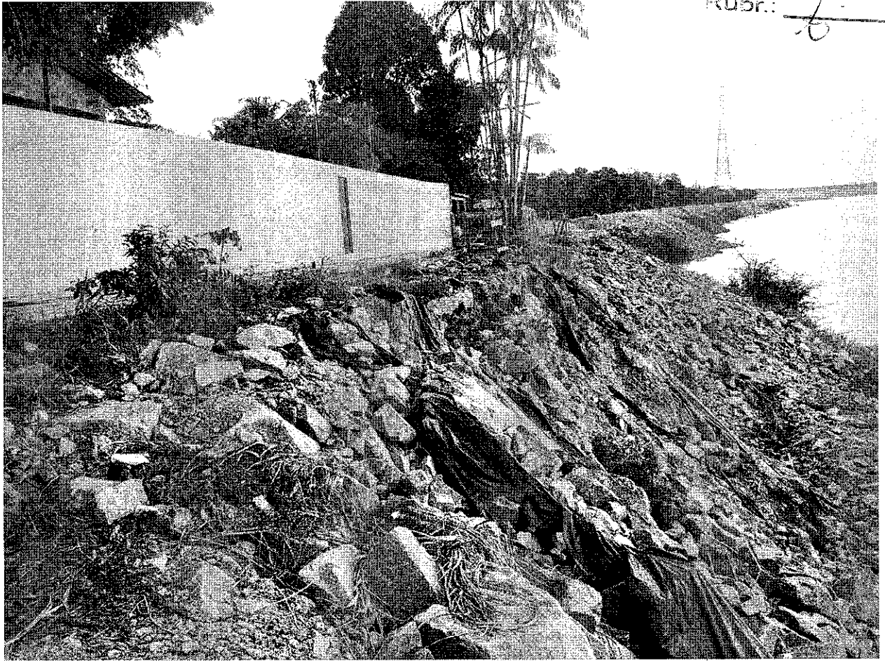
Foto 09 – Casa com muro recém construído próximo a talude desbarrancado. Não foi possível verificar se a moradia deveria ter sido evacuada ou não.
