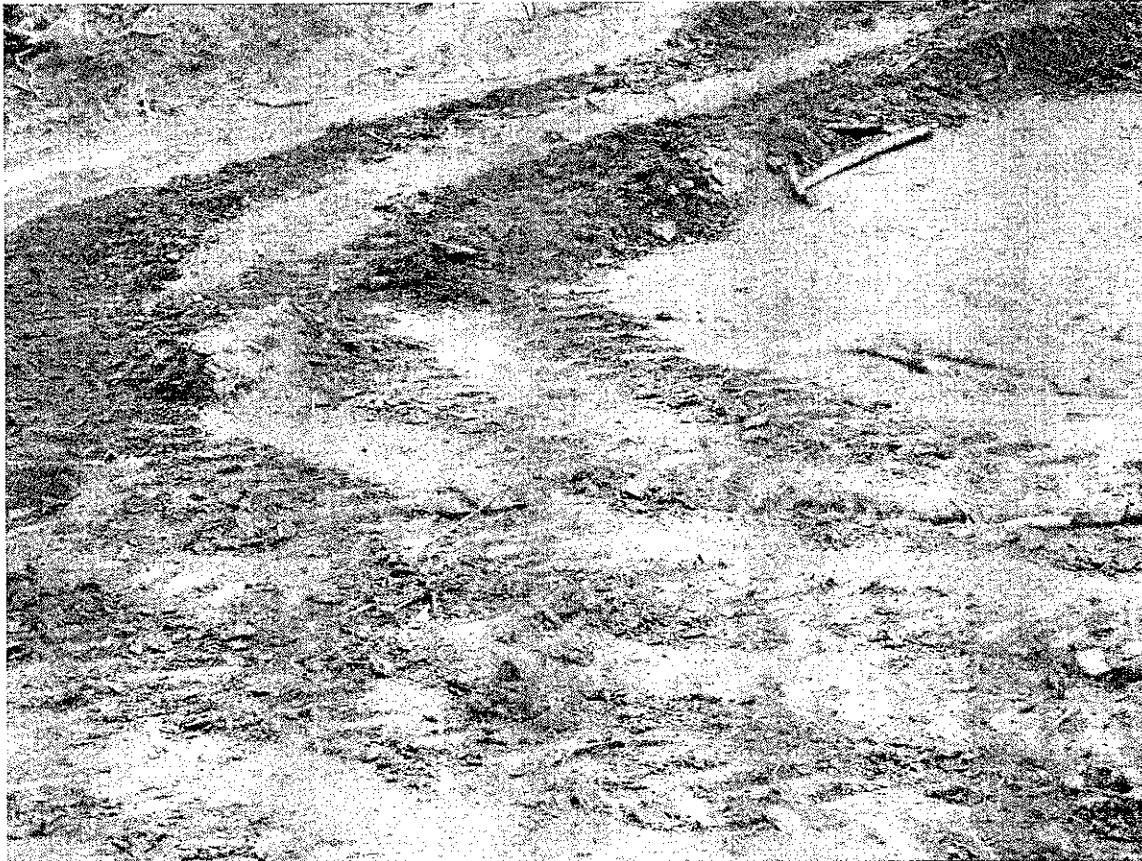
Foto 15 – Vala bem compactada, recompactação sem efeito.
