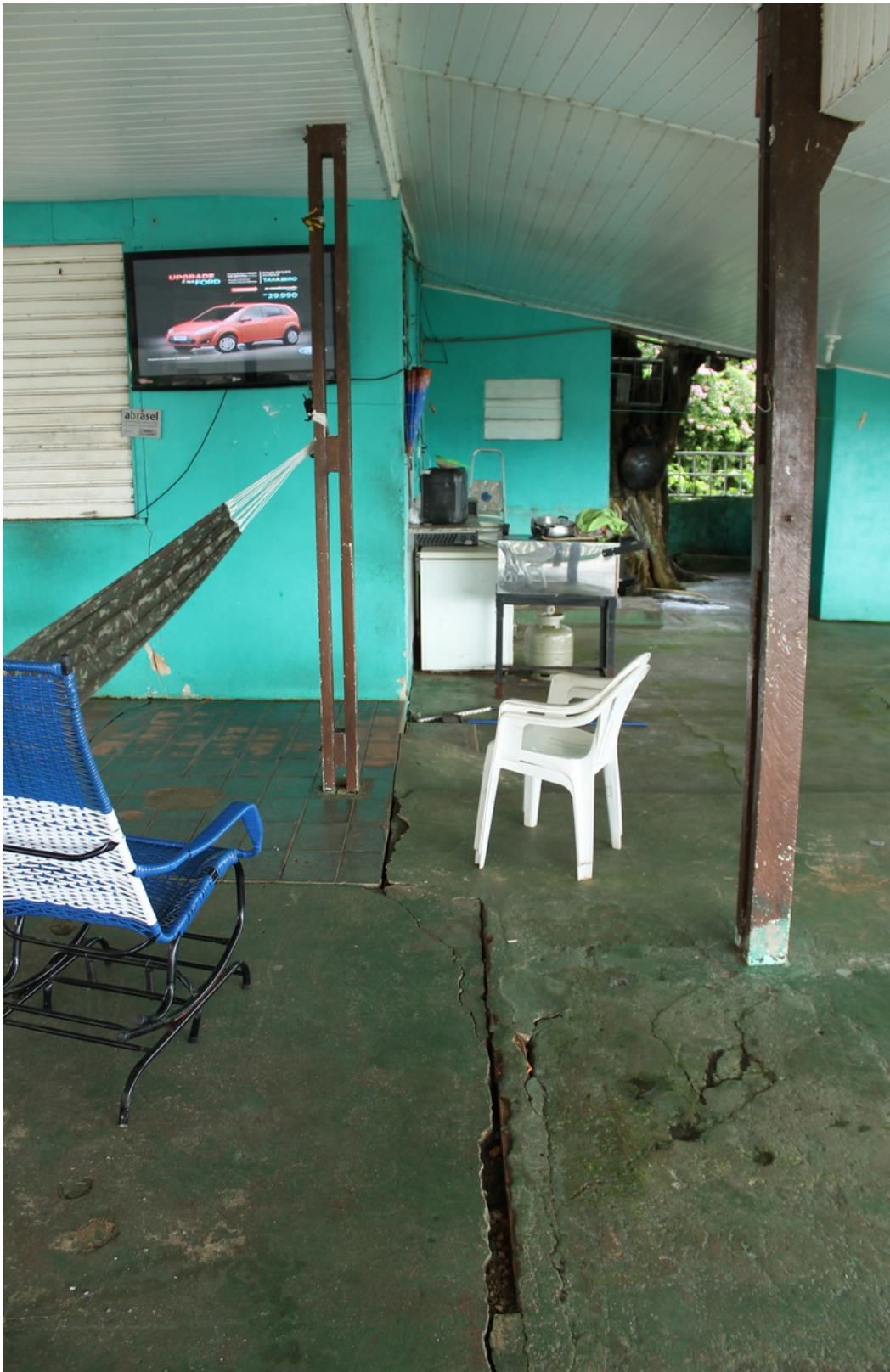
Foto 10 – Trincas no Mirante III.
