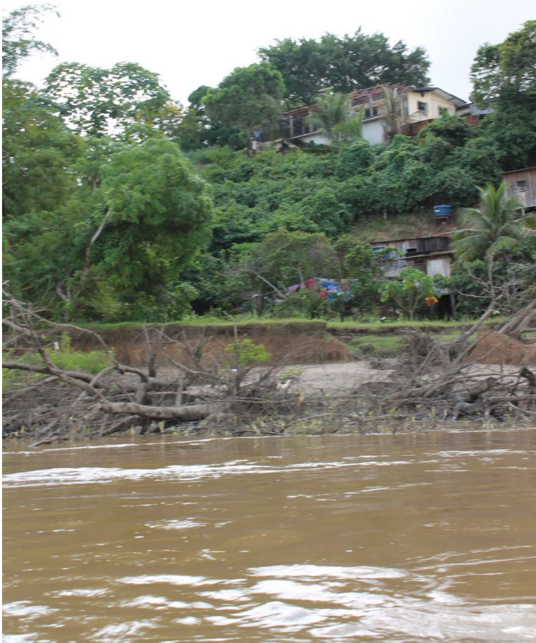
Foto 8 – Trecho das margens do rio Madeira com evidências dos processos erosivos.
