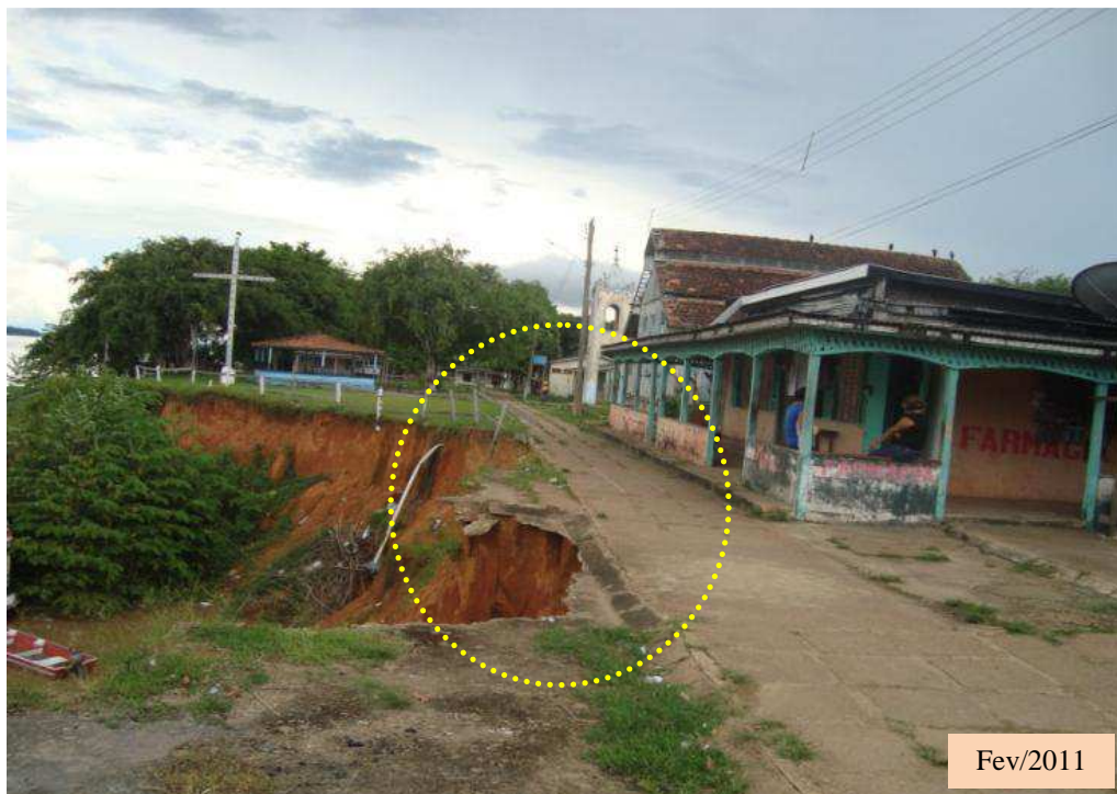
Figura 3.60 Detalhe do Processo Erosivo no LM-13 em Fevereiro/2011, Agosto/2011, Julho/2012, Julho/2013 e Agosto/2014
