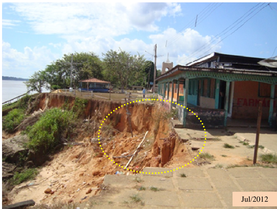
Figura 3.60 (continuação) Detalhe do Processo Erosivo no LM-13 em Fevereiro/2011, Agosto/2011, Julho/2012, Julho/2013 e Agosto/2014
