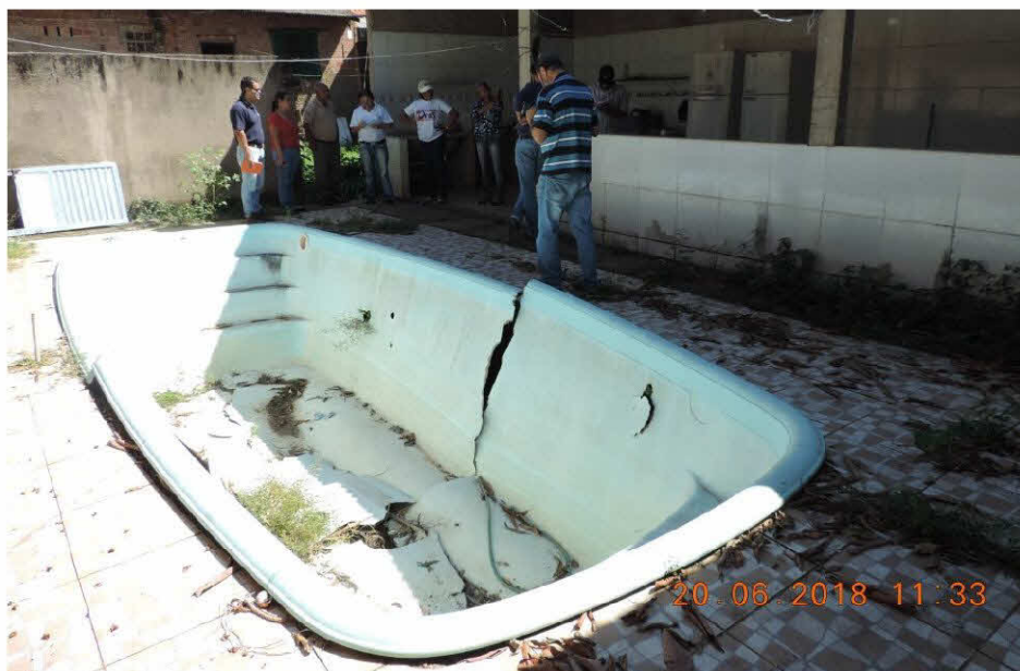
Figura 26 – Exemplo de problemas relacionados ao recalque diferencial.
