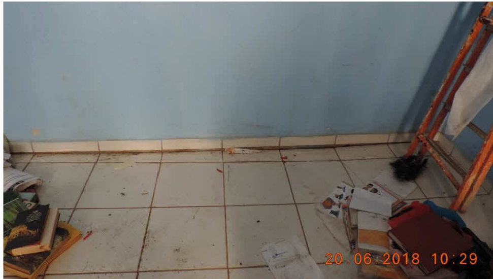
Figura 25 – Afundamento do piso em residência do distrito de Jacy-Paraná.
