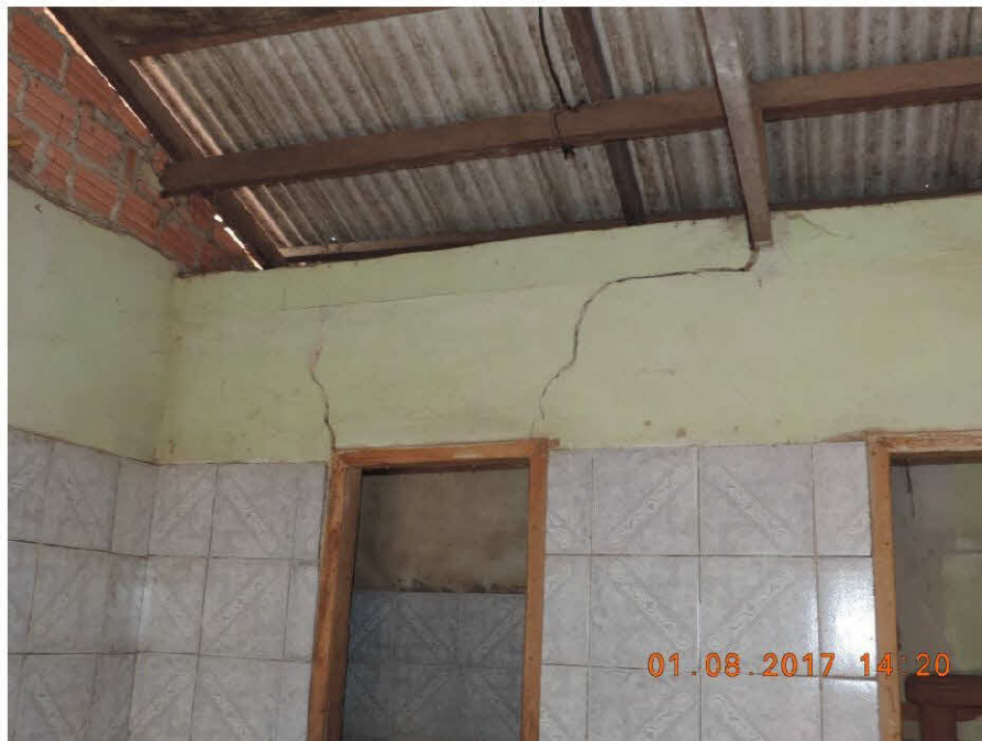
Figura 24 – Fissuras em painel de alvenaria contatada em visita a uma residência do distrito de Jacy-Paraná.
