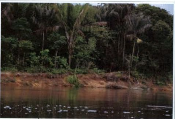
Foto 05: Área onde o enrocamento se encontra submerso podendo-se observar início de processo erosivo e palmeiras caídas.
