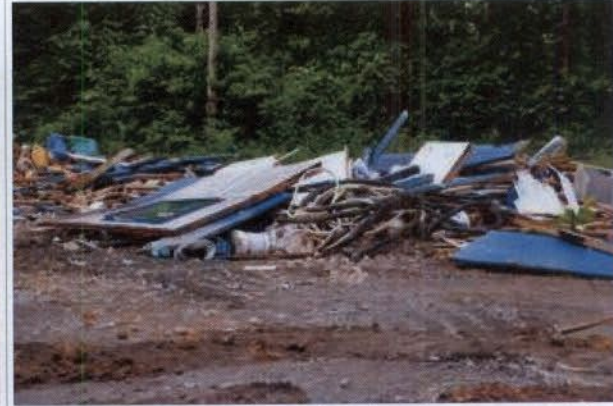
Foto 10: Local onde havia o canteiro administrativo. Observa-se ainda a presença de resíduos das construções existentes.
