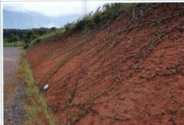
Foto 38: Talude próximo à área onde passa a linha de transmissão que precisa ser replantado.
