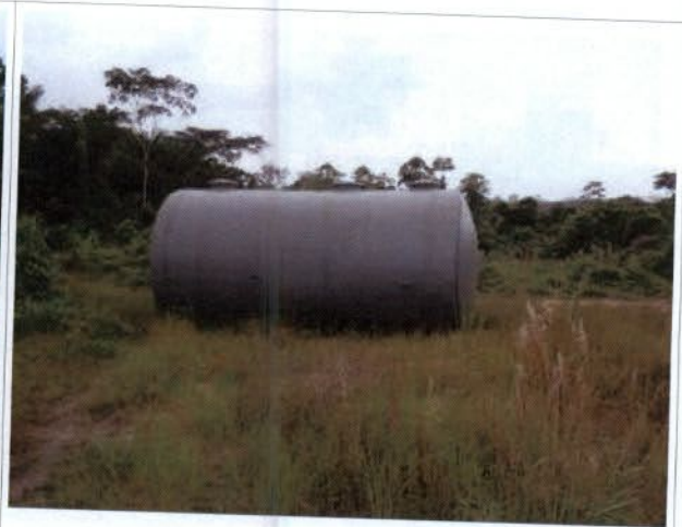
Foto 24: Tanque para Tratamento de Esgoto da ETE.
