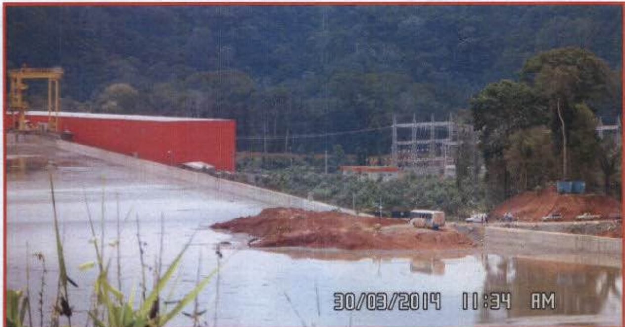
FOTO 03- VISTA DA BARRAGEM CCR, ONDE SE OBSERVA O NÍVEL DA ÁGUA APÓS A RUPTURA DA ENSECADEIRA, A CASA DE FORÇA EM VERMELHO (CASA DAS MÁQUINAS) E NO CENTRO ONDE EXISTE UM ÔNIBUS ESTACIONADO ESTÁ SERVINDO COMO CENTRO DE COMANDO DO CORPO DE BOMBEIROS QUE ESTÃO TRABALHANDO NO RESGATE DOS CORPOS DOS FUNCIONÁRIOS DESAPARECIDOS NO INCIDENTE, ACESSO ÀS EMBARCAÇÕES DE APOIO.
