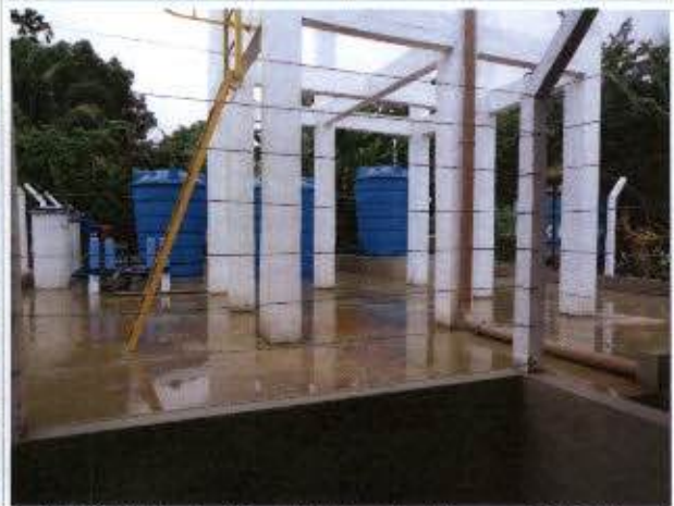
Foto 8: Detalhe do sistema de tratamento de água na Vila Padaria.
