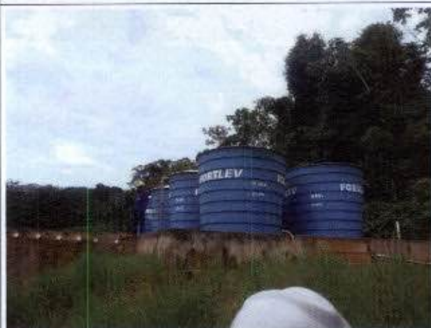
Foto 07: Estação de Tratamento de Água do canteiro secundário.
