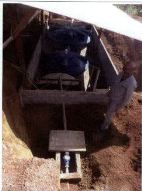
Foto 01: Sistema de fossa do alojamento em funcionamento.
