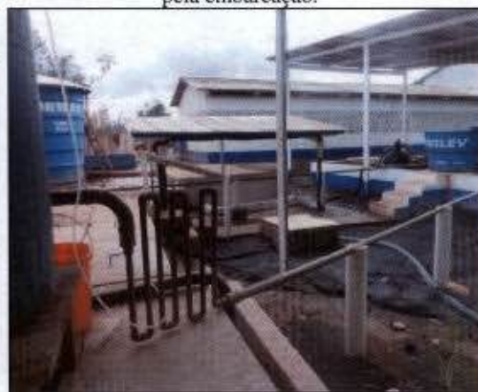
Foto 26: Novo sistema de tratamento do efluente gerado na rampa de lavagem (canteiro principal): recirculação.
