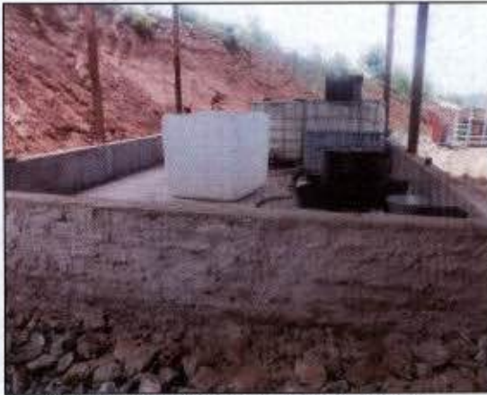
Foto 11: Bacia de contenção dos produtos perigosos gerados na "área de manutenção remota" (canteiro secundário).
