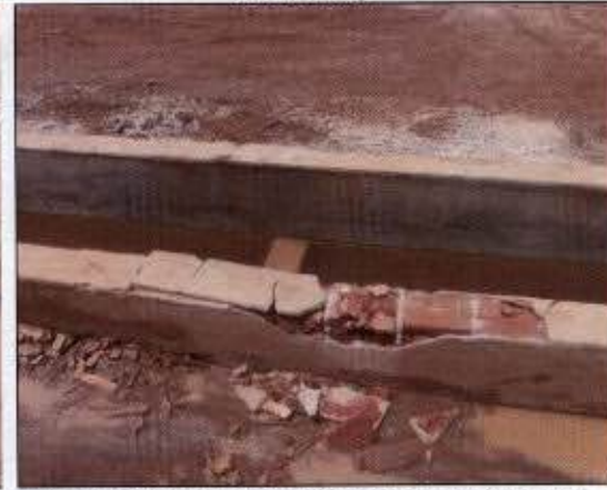
Foto 16: Canaleta quebrada do sistema da central de resíduos (canteiro secundário).
