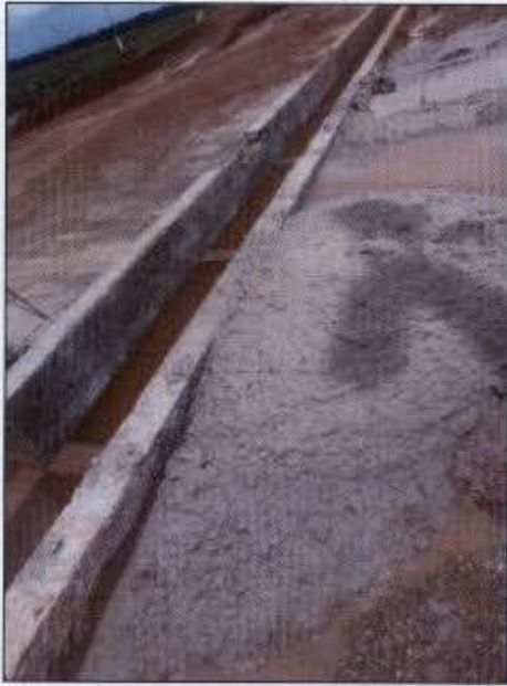
Foto 17: Cimento derramado na área da central de concreto (canteiro secundário).
