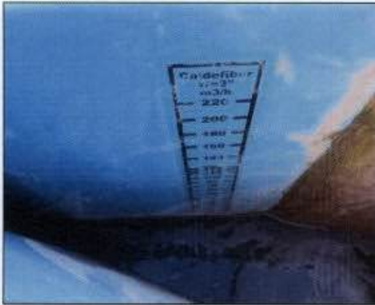
Foto 29: Calha Parshall da Estação de Tratamento de Esgoto (ETE) do canteiro principal.
