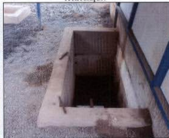
Foto 28: Ausência de tambor metálico na separação água/óleo do efluente gerado na rampa de lavagem (canteiro principal).
