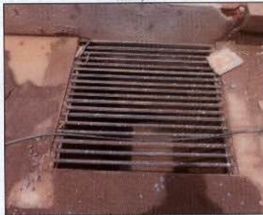
Foto 15: escoamento de água pluvial abaixo da canaleta do sistema de tratamento do efluente gerado na central de resíduos do canteiro secundário.
