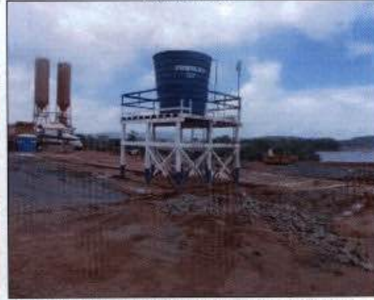
Foto 14: Caixa de recirculação do efluente tratado pelo sistema da central de concreto (canteiro secundário).
