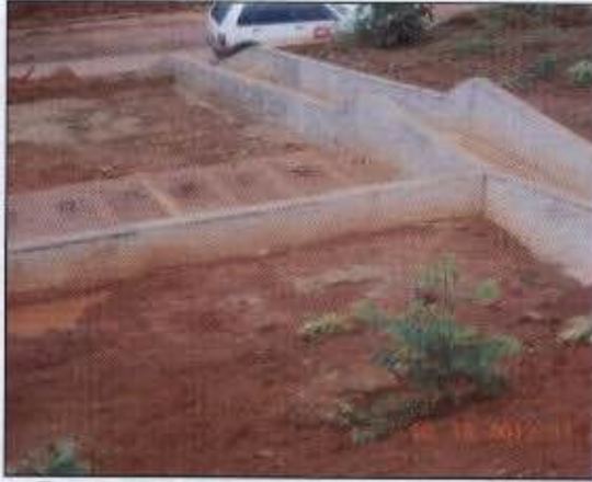
Foto 41: Talude semeado e com canaleta para escoamento de águas superficiais
