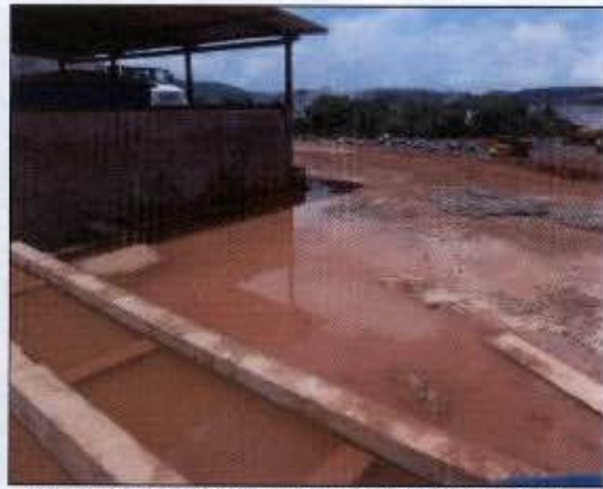
Foto 18: Efluente fora das canaletas (central de concreto).
