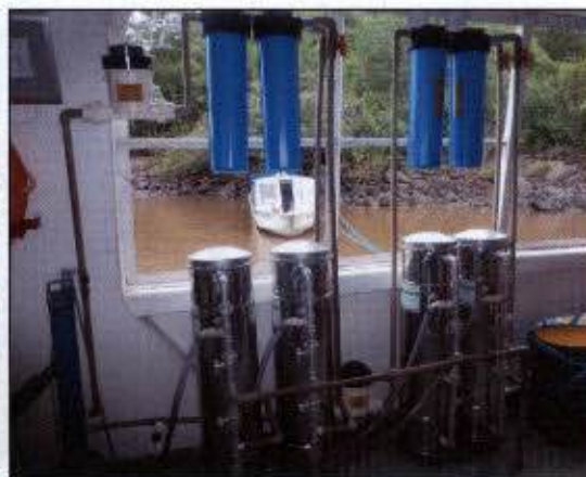
Foto 24: Sistema de tratamento da água captada pela embarcação.
