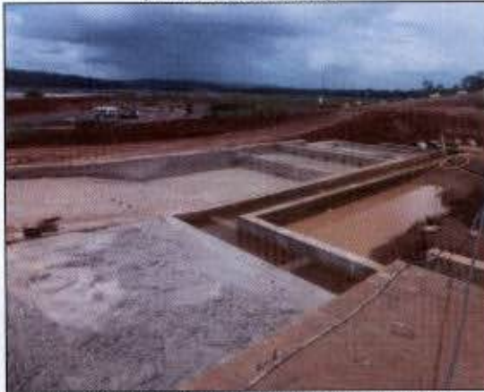
Foto 13: Sistema de tratamento da central de concreto do canteiro secundário (decantadores e filtro).
