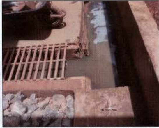
Foto 12: Sistema de contenção dos efluentes gerados na "área de manutenção remota" (canteiro secundário).
