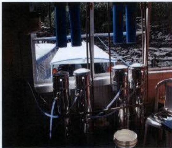
Foto 33- Alojamento Flutuante: Sistema simplificado de tratamento de água para o banho
