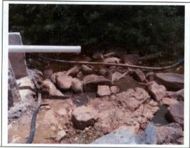
Foto 11: Visão geral da área no ponto de lançamento do efluente pós-tratamento pela caixa separadora de água/óleo; coloração indicativa de presença de óleo na água.
