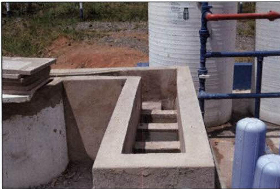
Imagem 01 – Vista do sistema de acesso a Calha Parshall
