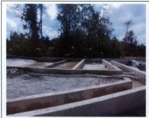
Foto 05: Sistemas de tratamento: tanque de lavagem das betoneiras e tanque dos efluentes gerados nas Centrais de Concreto.
