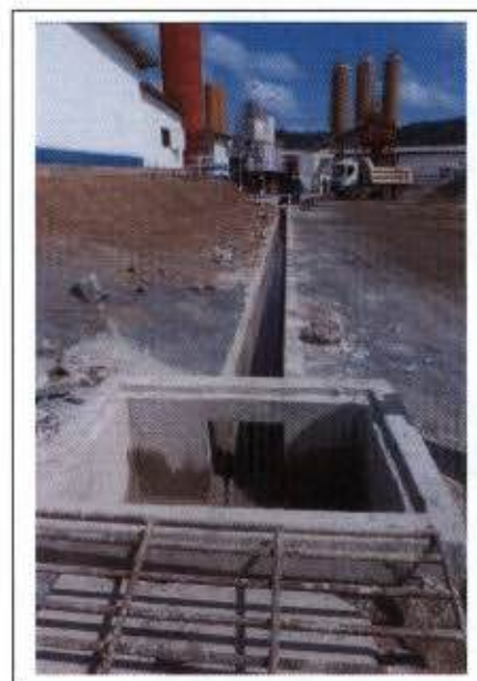
Foto 04: Canaletas das Centrais de Concreto direcionando o efluente para o tanque de tratamento.
