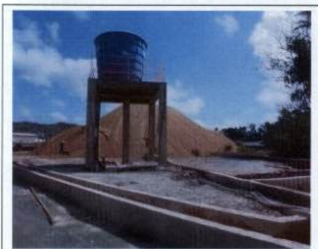
Foto 07: Caixa de armazenamento temporário da água que recircula no sistema da lavagem das betoneiras.
