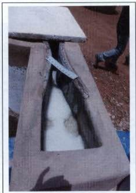
Foto 19: Calha Parshall para leitura da vazão de saída na Estação de Tratamento de Esgoto (ETE); inadequação (canteiro principal).
