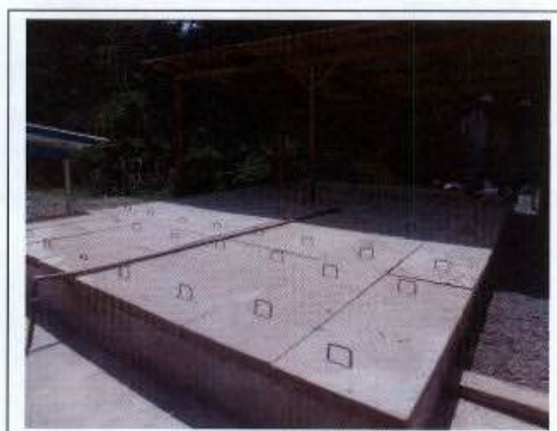
Foto 10: Nova caixa separadora de água/óleo implantada para o tratamento do efluente resultante da rampa de lavagem (canteiro principal).
