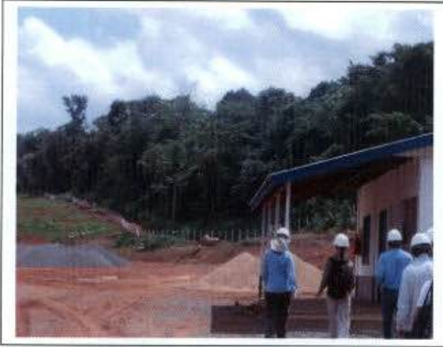
Foto 23: Cercamento do canteiro secundário e acesso para a comunidade da Vila de Santo Antônio.
