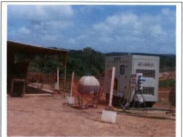
Foto 28: Combustível sem bacia de contenção e cobertura no canteiro secundário.
