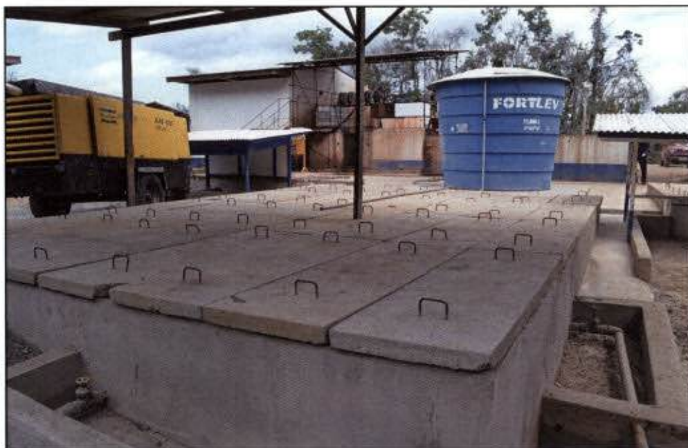
Imagem 04 – Caixa separadora de óleo
