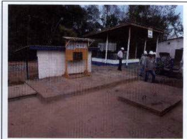
Foto 22 – Caixa de separação água/óleo advinda da Rampa de Lavagem
