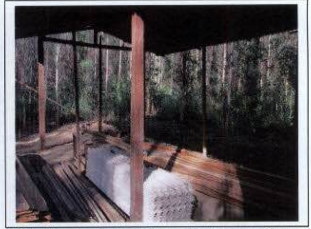
Foto 42 – Ampliação do Centro de Triagem de Fauna (Base de Resgate) do canteiro de obras
