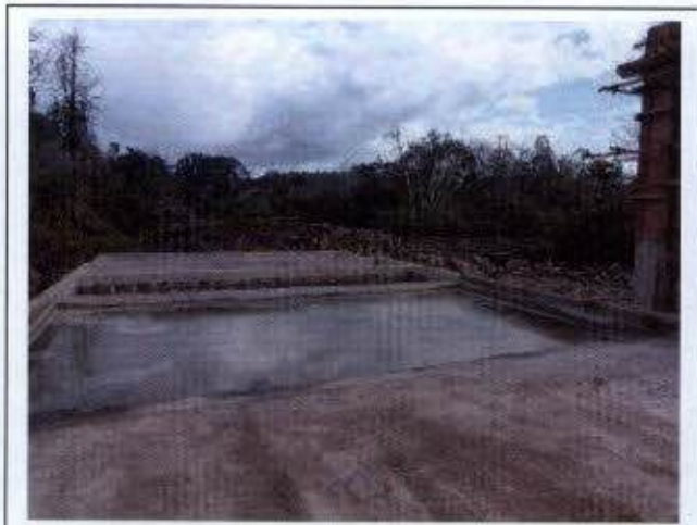
Foto 21 – Sistema de tratamento da água de lavagem das betoneiras (decantadores e filtro)
