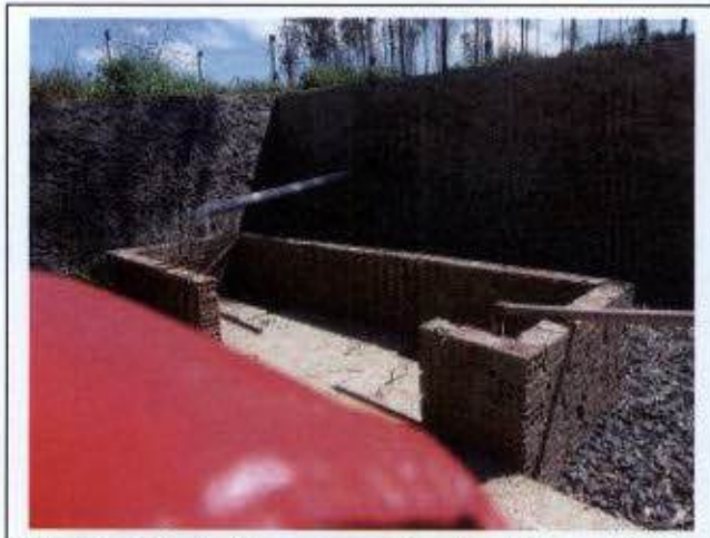
Foto 9 – Caixa de Concreto que Recebe o Efluente Tratado após a Filtragem, antes de ser lançado no Rio Jari
