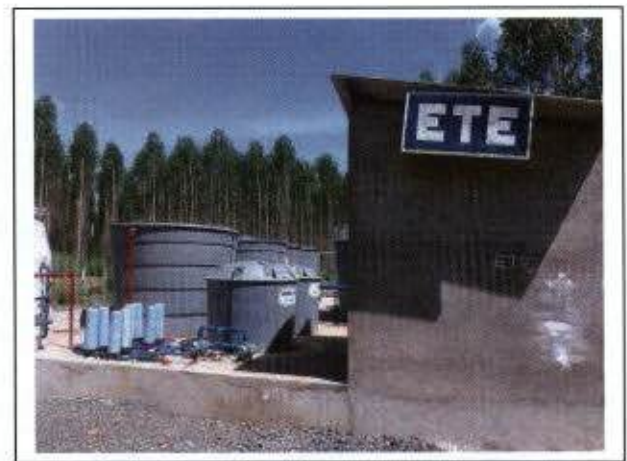
Foto 8 – Estação de Tratamento de Esgoto Compacta (ETE)
