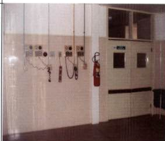
Foto 10: Detalhes de equipamentos do hospital de Monte dourado
