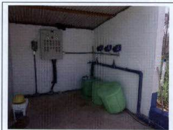
Foto 13 – Painel de controle da ETA e adição de cloro e sulfato na água captada
