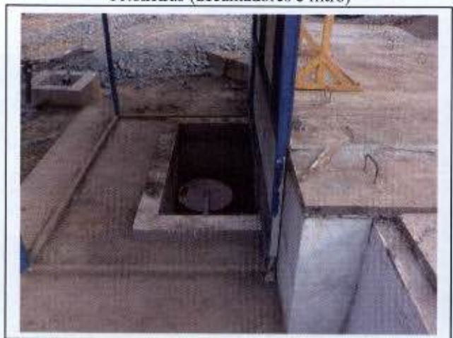
Foto 23 – Caixa de Concreto que armazena o óleo Separado
