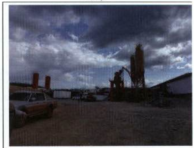
Foto 18 – Visão geral das centrais de concreto
