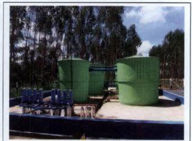
Foto 14 – Visão geral da ETA
