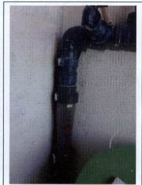
Foto 12 – Medidor de vazão na entrada da estação de tratamento de água (ETA)
