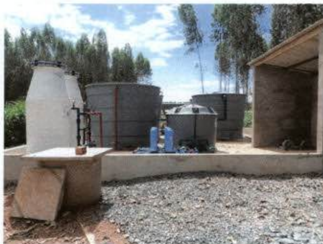
Foto 05: Estação de tratamento de esgoto
