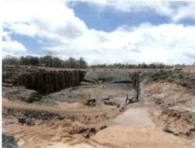
Foto 07: Local da casa de máquinas
