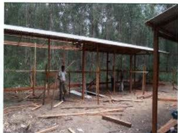
FOTO 04 - Construção do Centro de Triagem na margem direita do rio Jari para dar apoio às atividades de resgate de fauna na área do canteiro de obras. Recintos para abrigo da fauna resgatada.
