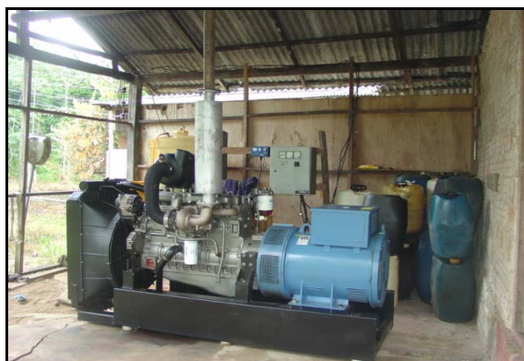
Figura 8.4-32 - Gerador de energia elétrica da Vila de Iratapuru
