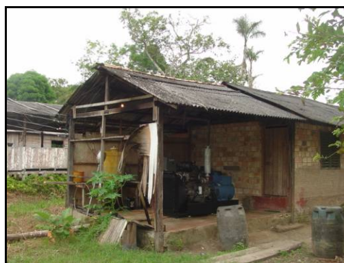
Figura 8.4-92 - Instalação para guardar o gerador de energia da vila de Iratapuru.
