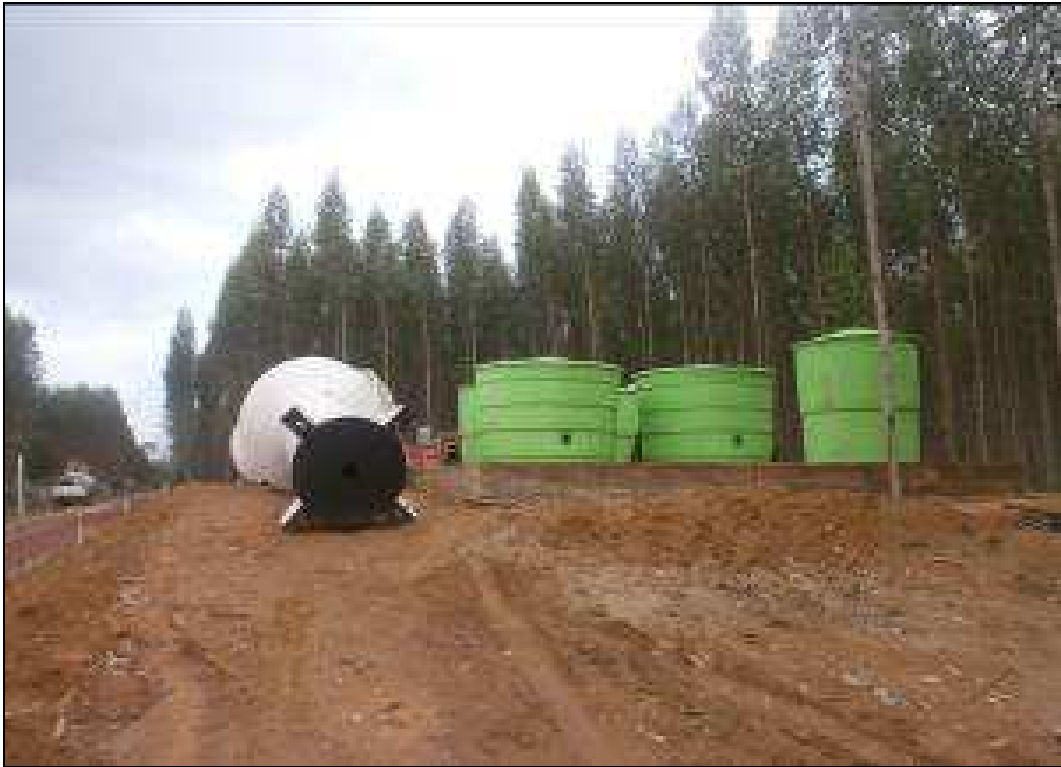
Foto 23 – Instalações das caixas d'água e Estação de Tratamento de Água (ETA)
