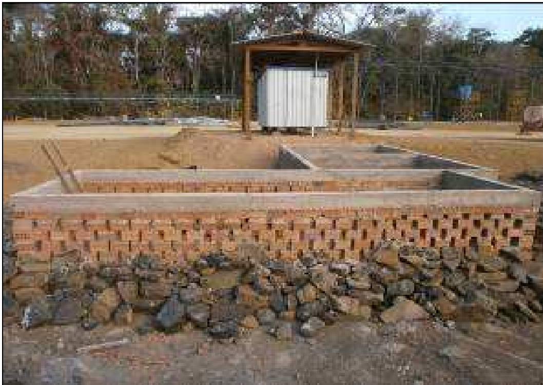
Foto 35 – Sistema fossa, filtro e sumidouro na área do canteiro industrial.
