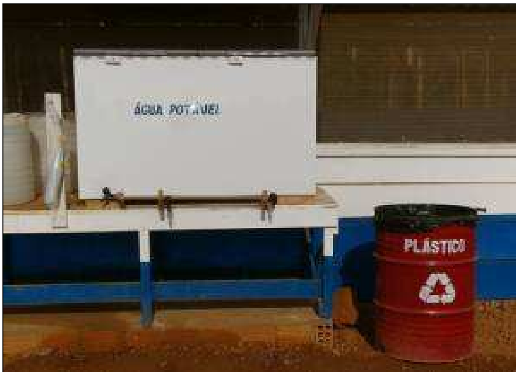
Foto 24 – Bebedouro de água potável instalado em canteiro provisório.
