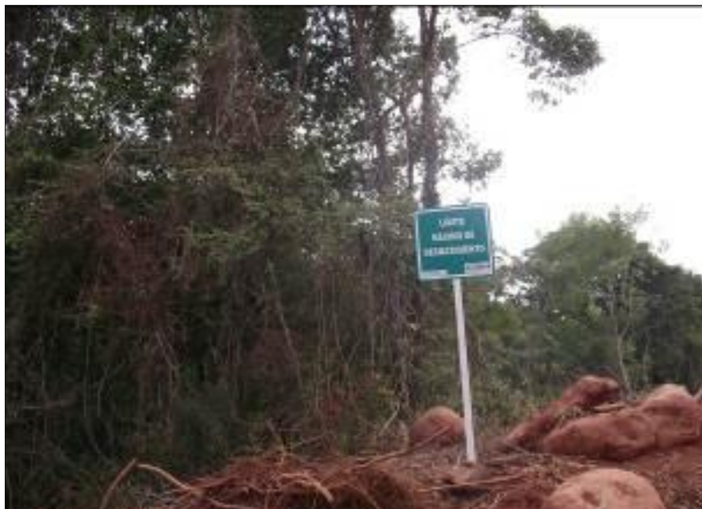
Foto 26 – Placas indicativas dos limites de desmatamento na área do canteiro de obras.
