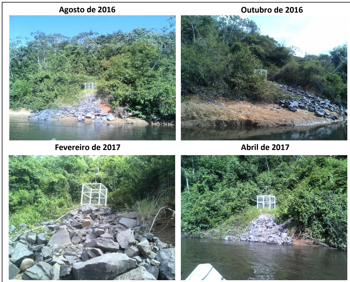
Figura 8. Vista para o enrocamento implantado no ponto MJE-06 nas campanhas de agosto e outubro de 2016, e fevereiro e abril de 2017.
