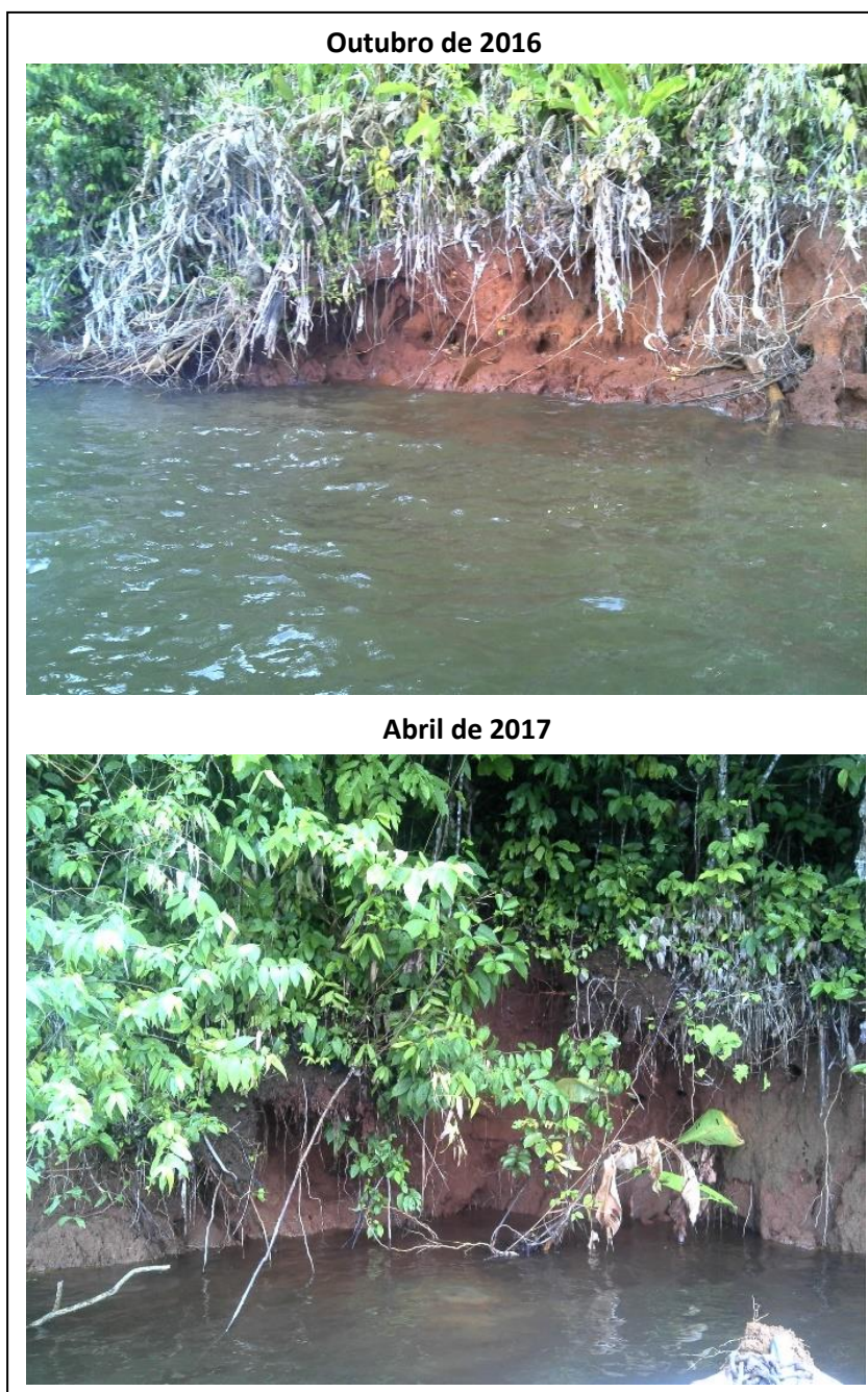
Figura 30. Ponto MM3-D localizado entre as coordenadas 22M 330218/9929540 e 22M 330175/9929424. Talude marginal sub-vertical com 135 metros de extensão e ocorrência de solapamentos em outubro de 2016 e abril de 2017.
