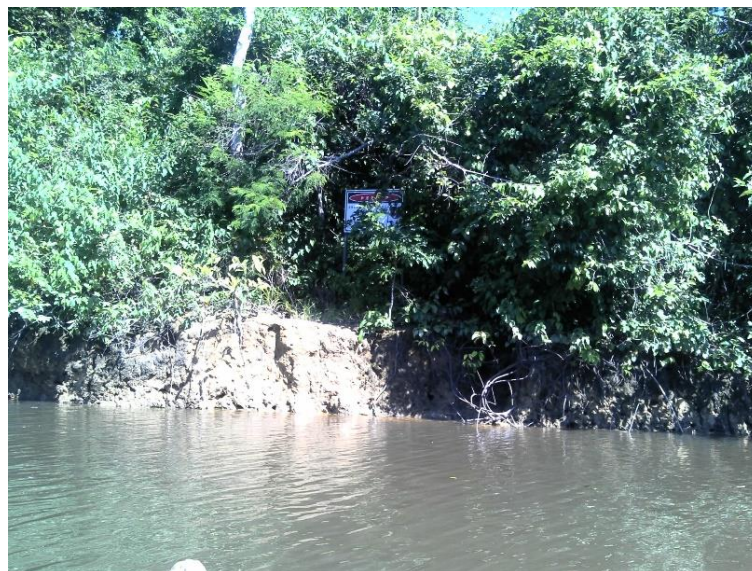
Figura 3.3.15-9: Ponto MJD-07 no Trecho erosivo do Canal Intermediário em junho de 2016.
