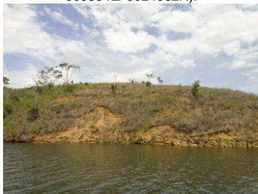
Figura 16 – Foco Erosivo P13 (Coord. UTM 365605E/ 8024064N).
