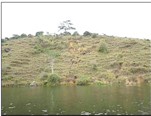
Figura 40 – Foco erosivo P7 (Coord. UTM 366902E/8023348N).
