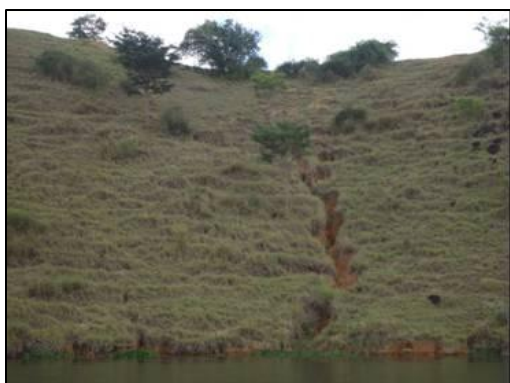
Figura 37 – Foco erosivo no ponto P8.
