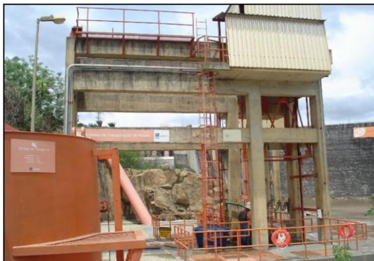
Figura 51 – Vista geral da STP.
