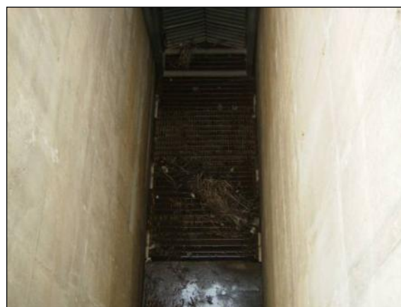
Figura 67 – Limpeza da grade de fundo.
