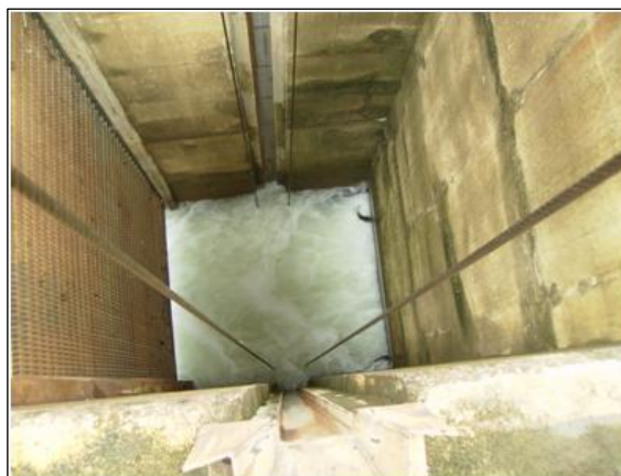
Figura 82 – Detalhe da caçamba submersa.
