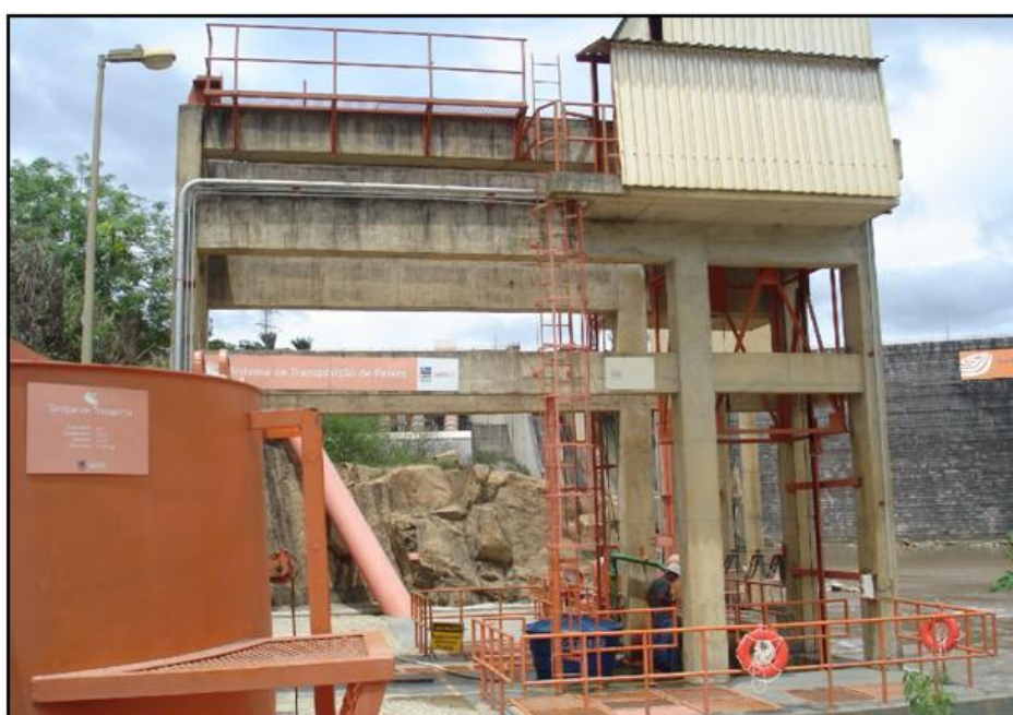
Figura 42 – STP (vista geral).
