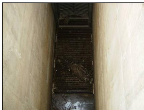
Figura 58 – Limpeza da grade de fundo.
