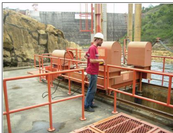
Figura 80 – Detalhe da operação do STP.
