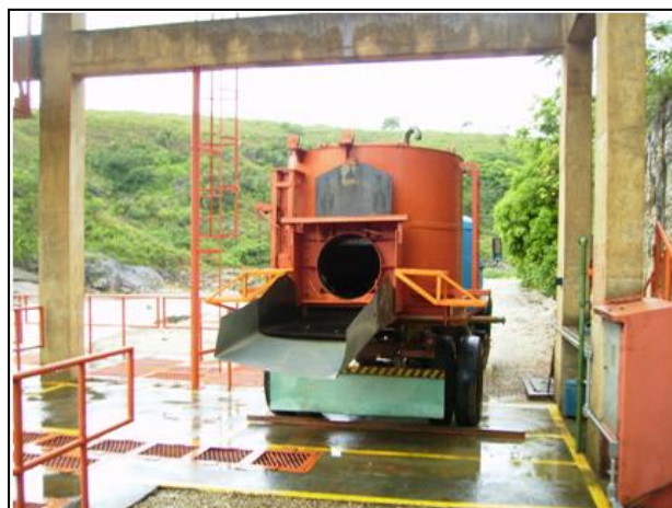
Foto 21 – Manutenção do STP.
