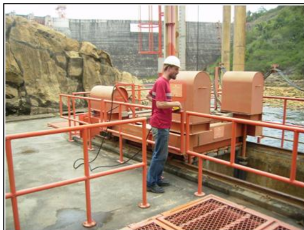
Foto 31 – Detalhe da operação do STP.
