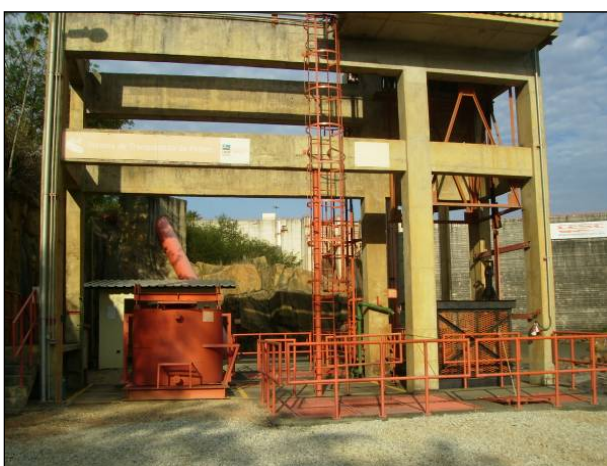
Foto 16 – Manutenção do STP.
