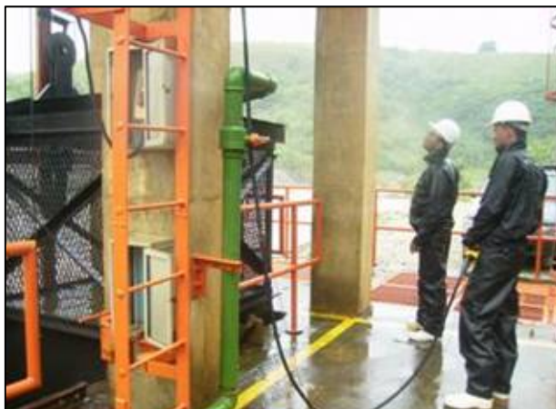
Foto 30 – Operação do STP.
