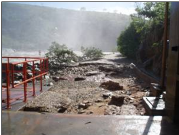
Foto 35 – Acesso danificado pelas cheias.
