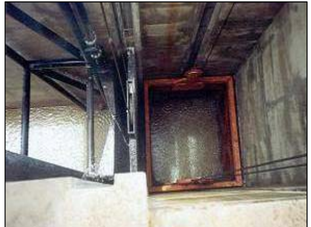
Foto 5 – Grade confinadora, grade móvel e caçamba.
