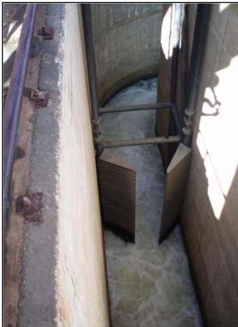
Foto 2 – Canal de atração. Detalhe da grade confinadora.
