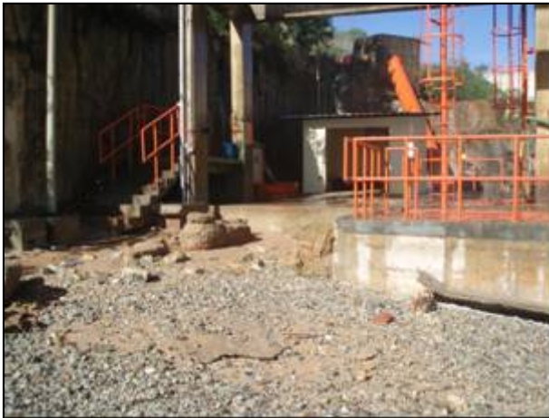
Foto 37 – Acesso danificado pelas cheias.
