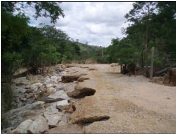
Foto 39 – Acesso danificado pelas cheias.
