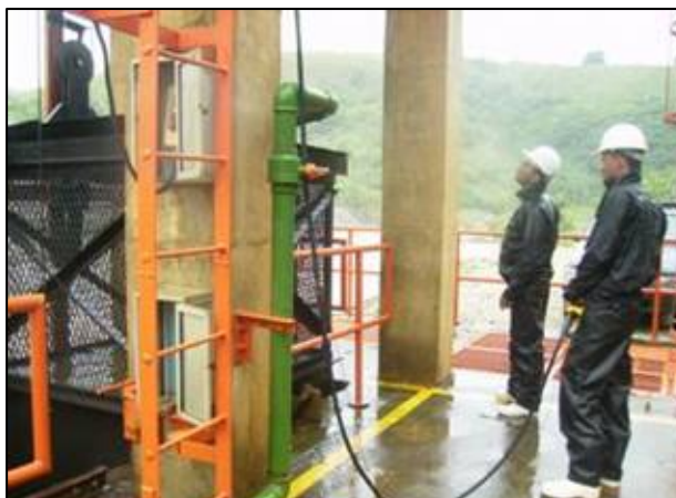
Foto 52 – Operação do STP.
