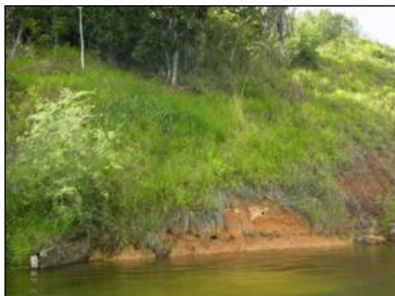
Foto 23 – Área erodida próximo à ombreira
