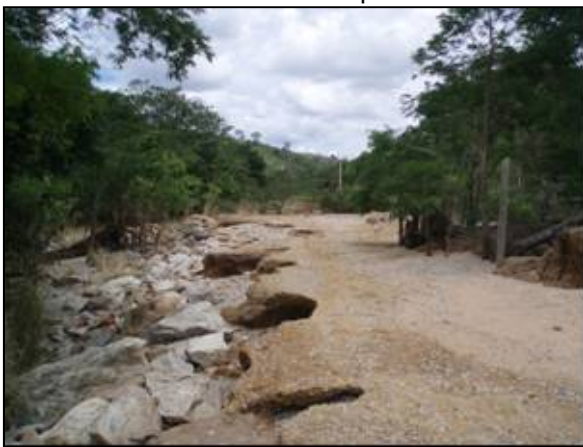
Foto 121 – Acesso danificado pelas cheias.
