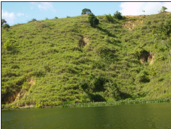
Foto 19 – Focos erosivos em recuperação e estabilização. Próximo à margem, em processo de recrudescimento.
