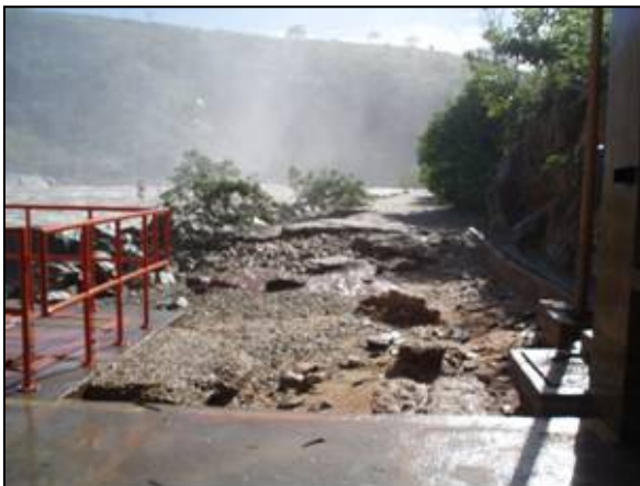
Foto 117 – Acesso danificado pelas cheias.
