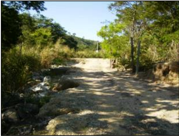
Foto 87 – Acesso após as cheias.
