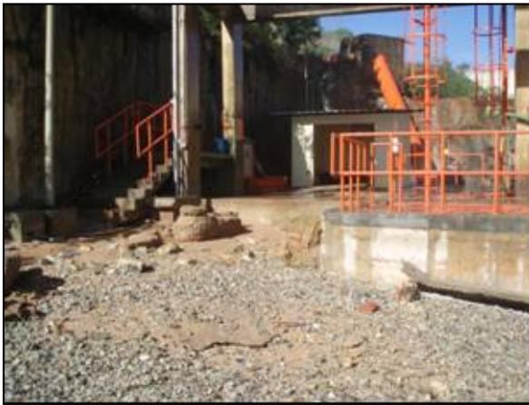
Foto 119 – Acesso danificado pelas cheias.
