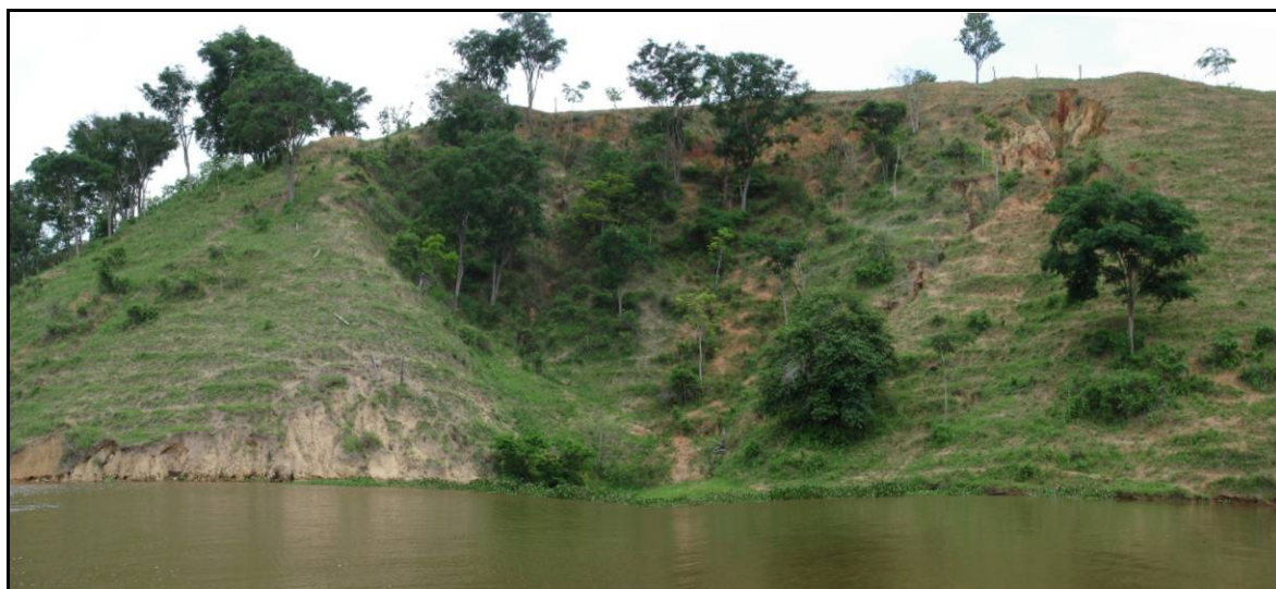
Figura 5.27 – Vista panorâmica do processo erosivo – ME / FOCO 13.
