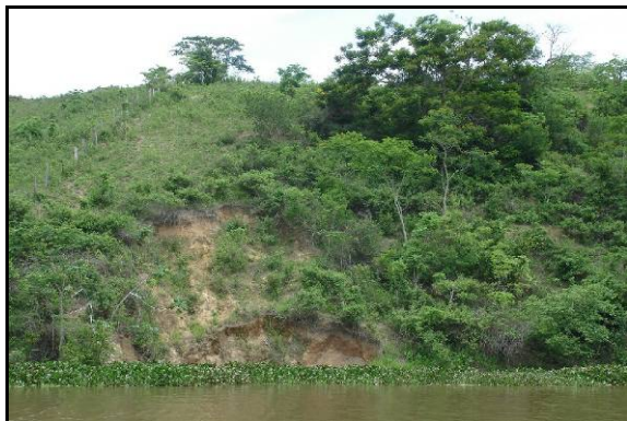
Figura 5.44 – Vista panorâmica do processo erosivo – MD / FOCO 25.
