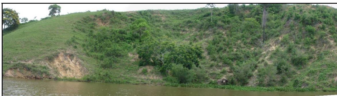
Figura 5.41 – Vista panorâmica do processo erosivo – ME / FOCO 22.
