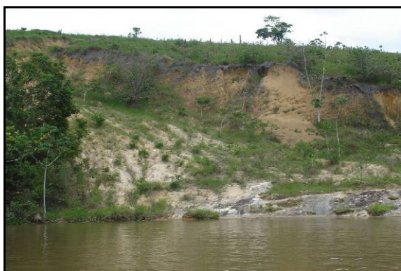
Figura 5.47 – - Vista panorâmica do processo erosivo – MD / FOCO 28.
