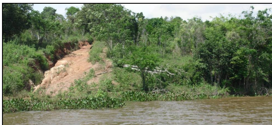
Figura 5.12 – Vista panorâmica do processo erosivo – MD / FOCO 10 .
