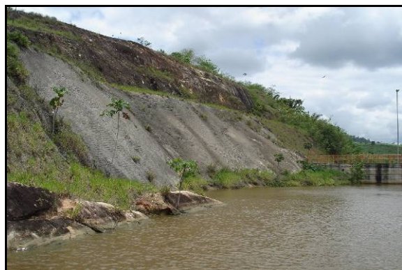
Figura 5.49 – Vista panorâmica do processo erosivo controlado próximo ao eixo da barragem. FOCO 29.
