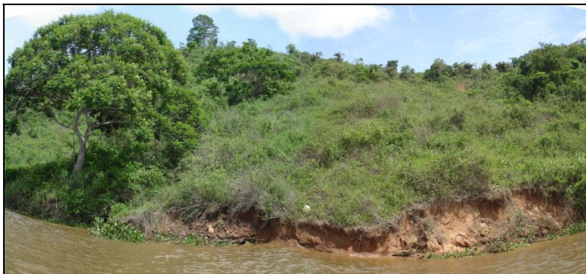
Figura 5.15 – Vista panorâmica do processo erosivo. Observar a grande cobertura vegetal estabelecida na parte superior do processo. – ME / FOCO 03.
