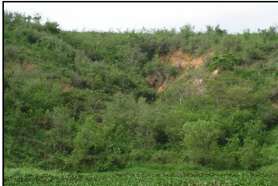
Figura 5.1 – Vista panorâmica do processo erosivo – MD / FOCO 01 . Observar a intensa ocupação por espécies lenhosas e herbáceas.
