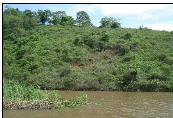
Figura 5.17 – Vista panorâmica do processo erosivo – ME / FOCO 05.
