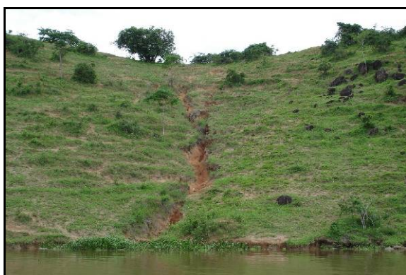
Figura 5.28 – Vista panorâmica do processo erosivo – ME / FOCO 14.
