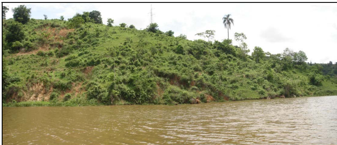
Figura 5.19 – Vista panorâmica do processo erosivo – ME / FOCO 07.
