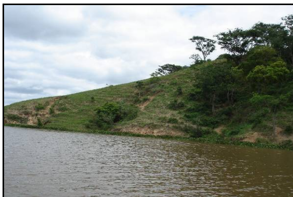
Figura 5.25 – Vista panorâmica do processo erosivo – ME / FOCO 12.
