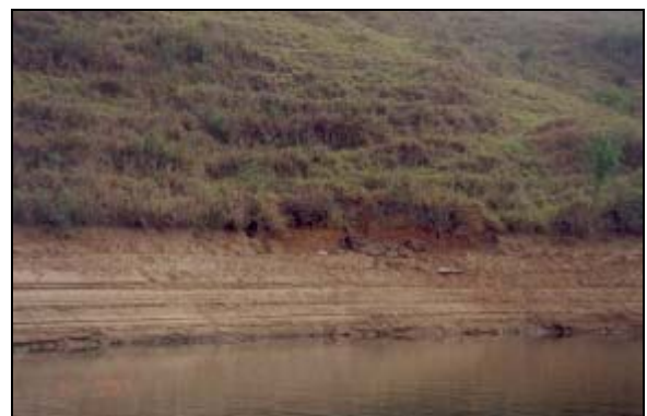
FOTO 7.28: SETOR 367/68, COORD. (UTM) 367.016 / 8.023.275, MARGEM ME. PROCESSO EROSIVO INSTALADO NA FAIXA ESTUDADA, CAUSANDO LEVE SOLAPAMENTO DE PROC. EROS. NA MARGEM, DE TAMANHO AINDA IRRELEVANTE, LOCALIZADO ACIMA DA ELEV.86, O QUAL NÃO TINHA SIDO IDENTIFICADO EM MONITORAMENTOS ANTERIORES.
