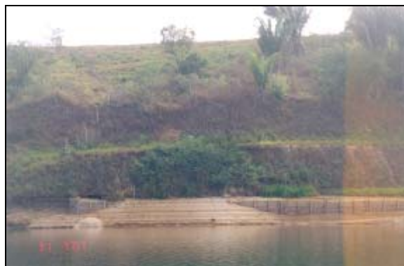
FOTO 7.39: SETOR 372/BARR, COORD. (UTM) 372.658 / 8.021.047, MARGEM ME. PROCESSO EROSIVO INSTALADO NA FAIXA ESTUDADA, AINDA SEM REFLEXOS NO PROCESO EROSIVO EXISTENTE NA MARGEM, ACIMA DA ELEVAÇÃO 86, IDENTIFICADO EM MONITORAMENTOS ANTERIORES COMO E-1A.
