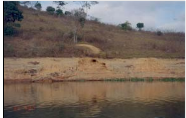
FOTO 7.18: SETOR 363/64, COORD. (UTM) 363.279 / 8.025.251, MARGEM MD. PROCESSO EROSIVO INSTALADO NA FAIXA ESTUDADA, AINDA SEM REFLEXOS EM ALGUM PROCESSO EROSIVO EXISTENTE NA MARGEM, ACIMA DA ELEVAÇÃO 86.
