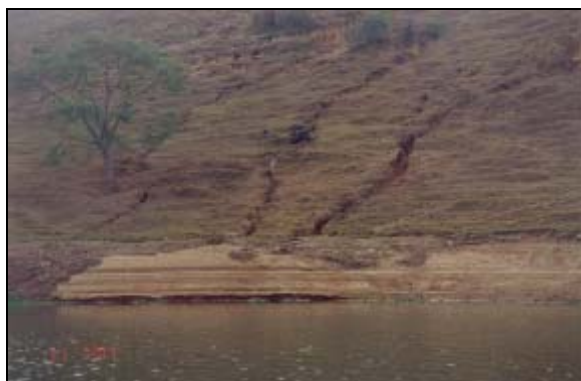
FOTO 7.27: SETOR 366/67, COORD. (UTM) 366.537 / 8.023.544, MARGEM ME. PROCESSO EROSIVO INSTALADO NA FAIXA ESTUDADA, AINDA SEM REFLEXOS NO PROCESO EROSIVO EXISTENTE NA MARGEM, ACIMA DA ELEVAÇÃO 86, IDENTIFICADO EM MONITORAMENTOS ANTERIORES COMO E-11A.
