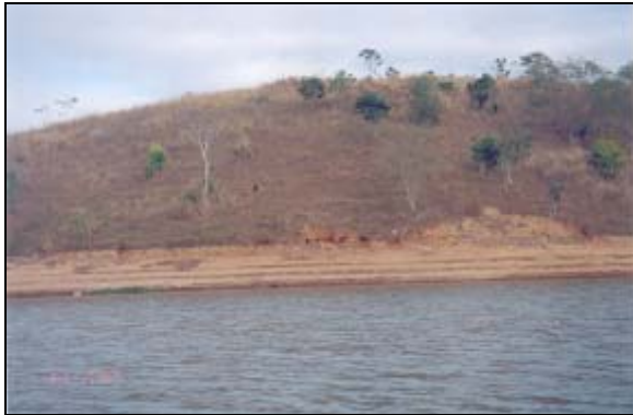
FOTO 7.13: SETOR 365/66, COORD. (UTM) 365.399 / 8.023.424, MARGEM MD. PROCESSO EROSIVO INSTALADO NA FAIXA ESTUDADA, CAUSANDO SOLAPAMENTO DE PROC. EROSIVO DE PEQUENA MONTA EXISTENTE NA MARGEM, ACIMA DA ELEVAÇÃO 86, O QUAL NÃO TINHA SIDO IDENTIFICADO EM MONITORAMENTOS ANTERIORES.
