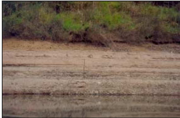
FOTO 7.25: SETOR 365/66, COORD. (UTM) 365.738 / 8.024.763, MARGEM ME. VISTA GERAL DE TRECHO DO SETOR, SEM NENHUMA OCORRÊNCIA DE PROCESSO EROSIVO INSTALADO.
