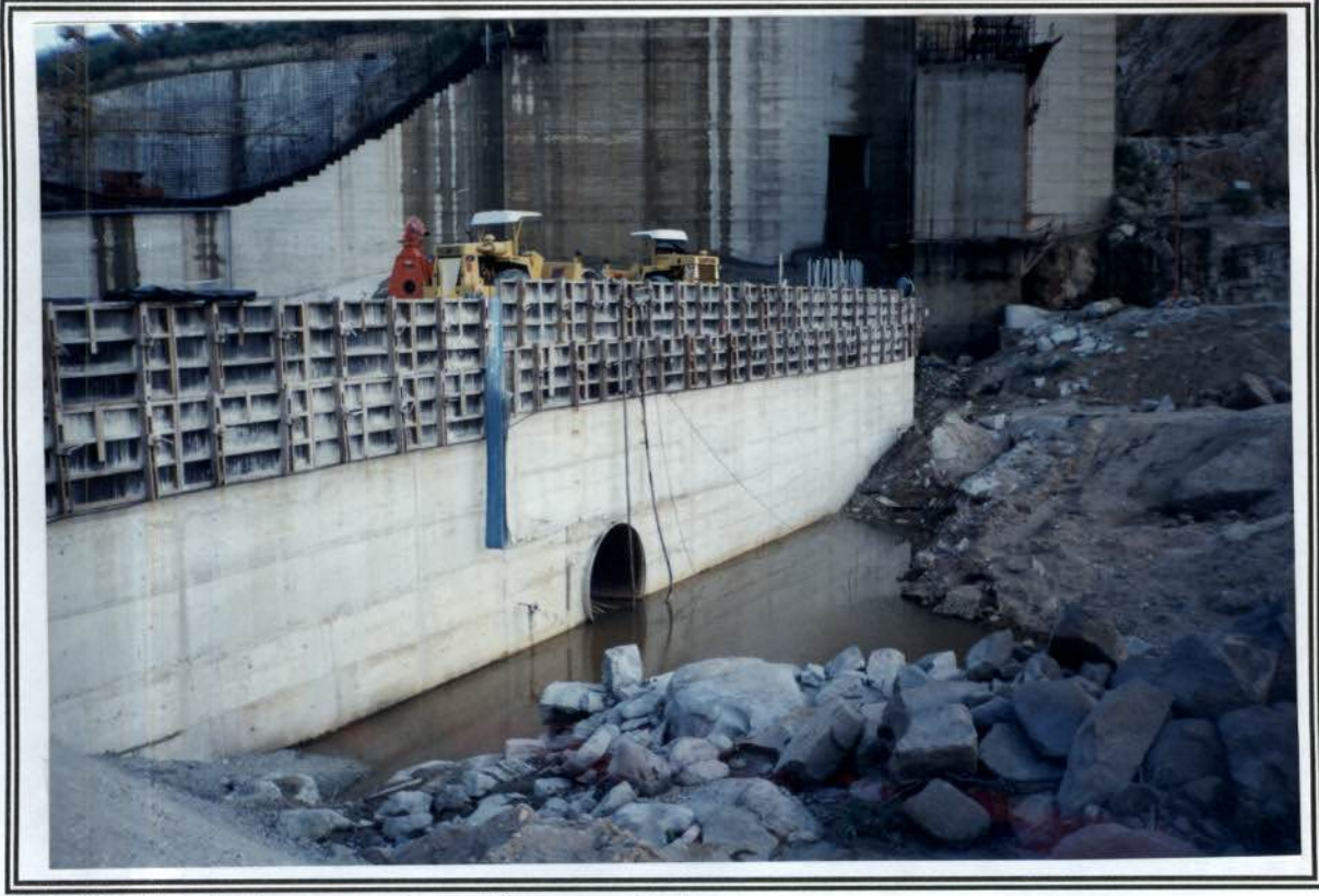
Foto 12 - Tubulação para vazão sanitária - montante.
