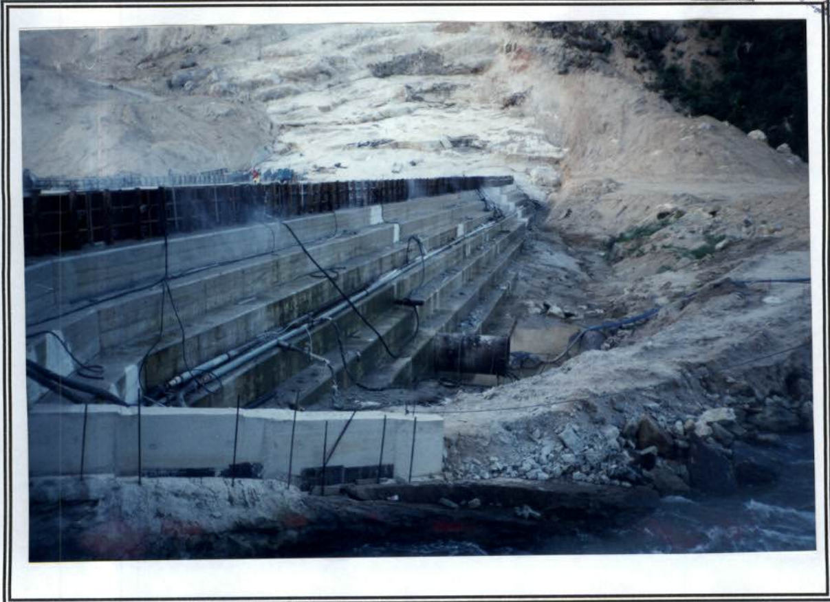
Foto 13 - Tubulação para vazão sanitária - jusante.
