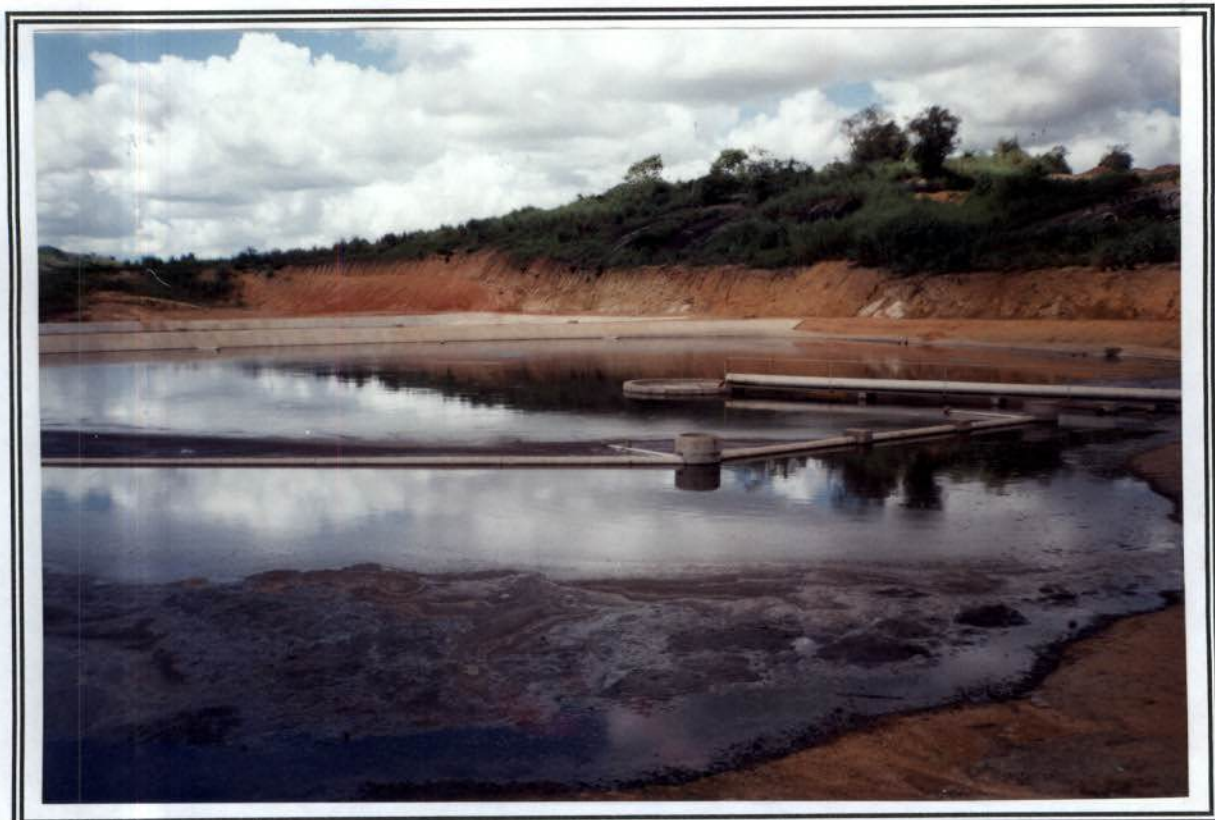
Foto 16 – Estação de Tratamento de Efluentes do FRISA.
